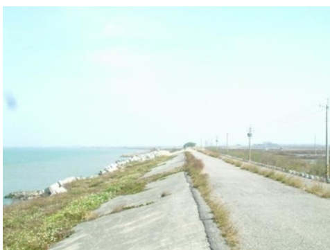
相片 4-1 堤頂裂縫
