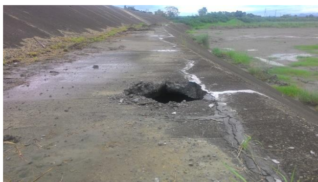
相片 4-4-堤坡戕台掏空下陷
