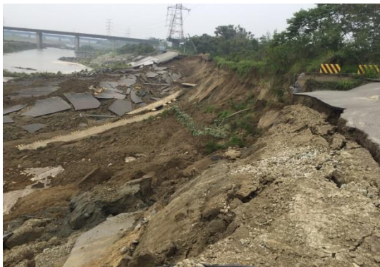
相片 4-5 日新護岸前坡滑動破壞
