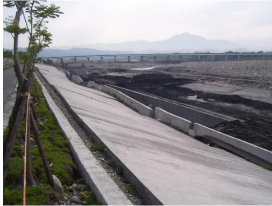
相片 4-25 堤防基腳工下陷拖拉坡面工向下位移破壞
