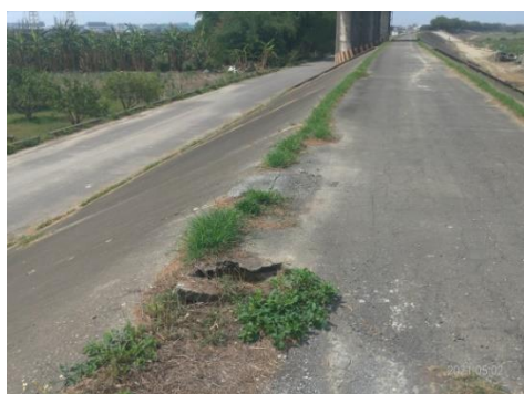
相片 4-3 堤頂掏空下陷
