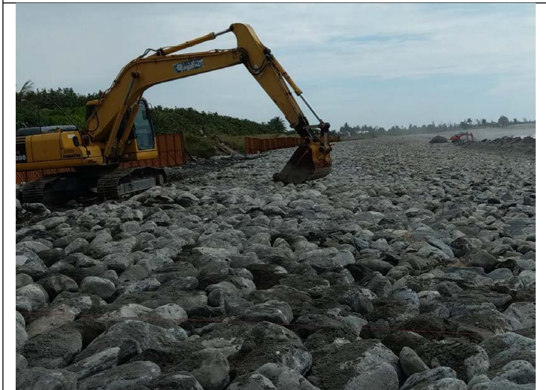
怪手開挖後方於完工後須加以植生，施工過程中須注意重機械油酯避免造成環境汙染。
