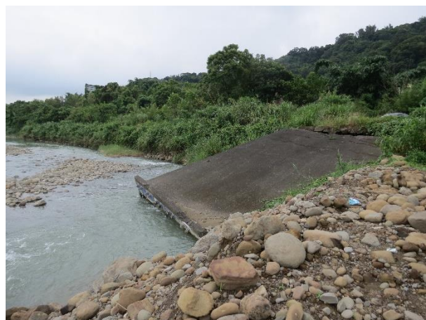
右岸水門破壞
