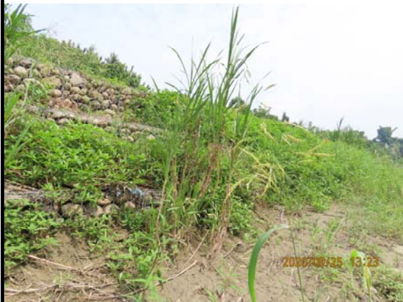
四工區石籠及堤前砌石已長滿草本植物。
