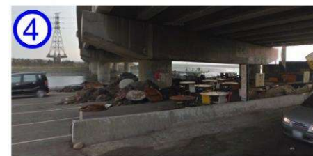
台61高架橋下堆放雜物
