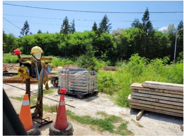
施工材料現地放置現況
