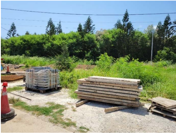
施工材料現地放置現況
