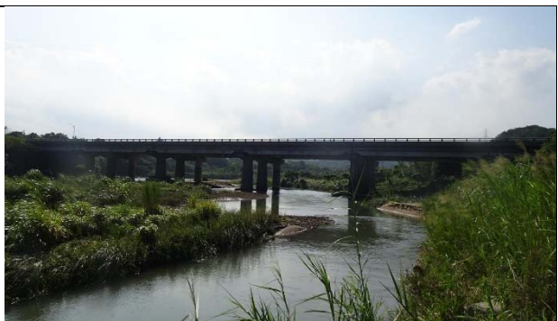
環境照-龍門橋
