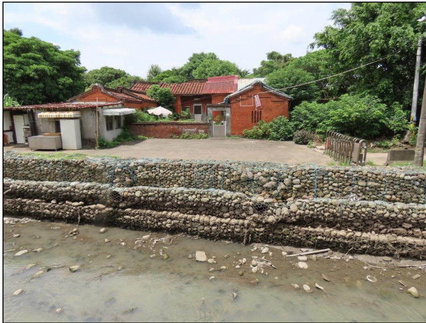
圖 5-2 「淡水區樹梅坑溪出河口段石籠修復工程」損壞石籠護岸現況圖
