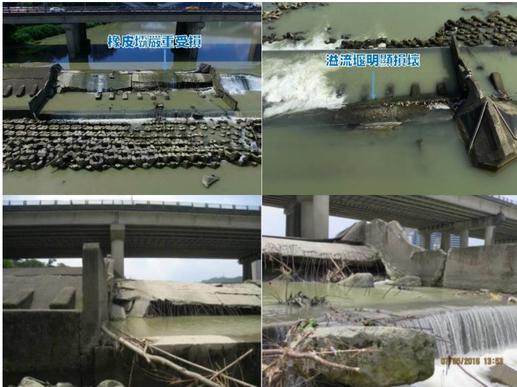
圖 2 碧潭堰損壞情形嚴重
