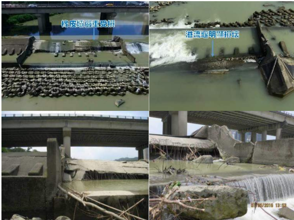
圖 2 碧潭堰損壞情形嚴重
