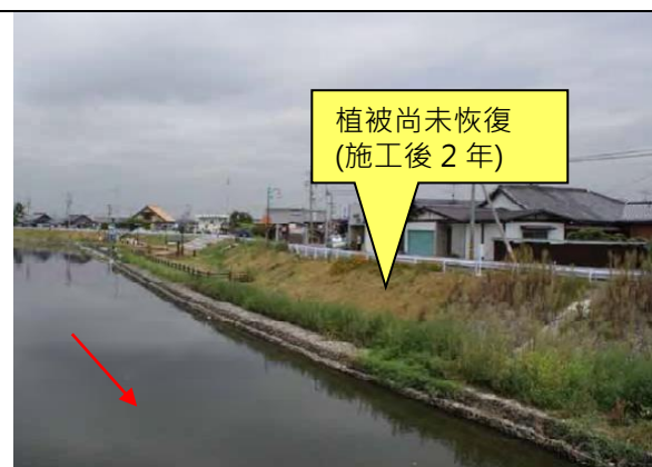
④ 左岸側水際線石籠裸露
