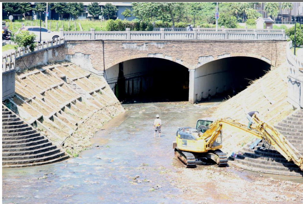
圖 4-19 公司田溪格樑護坡影響通水斷面
