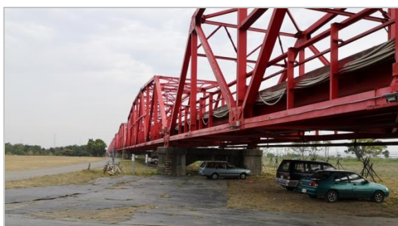
西螺大橋橋下空間被汽車停放佔用
