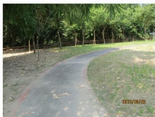
H. 步道兩側排水不良導致土漫流至步道
