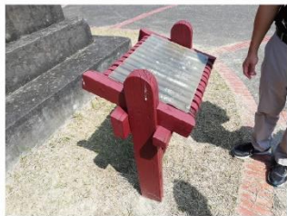
F. 園區內解說設施年久失修
