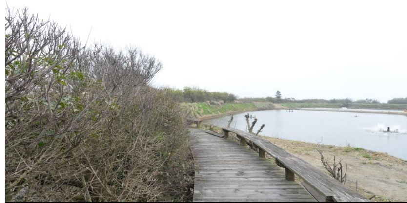
1.烏魚魚池木棧道破損行走危險
