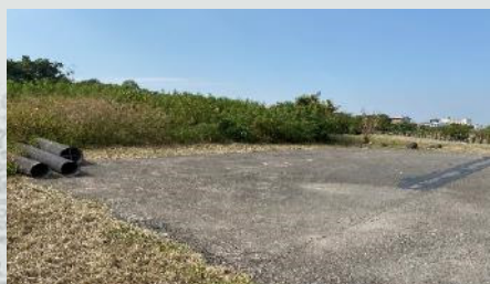
5. 停車場瀝青鋪面已有龜裂破損之情形，影響安全
