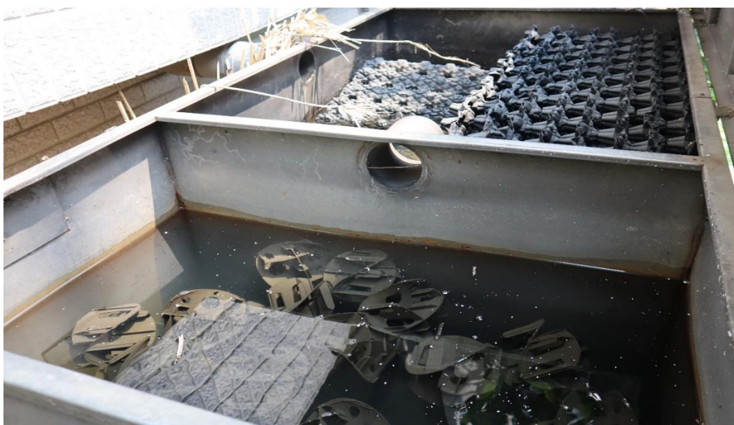
範例：沉澱過濾槽(新北光華國小)
