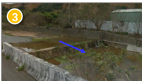
0K+274大型固床工左岸附掛PVC管取水
