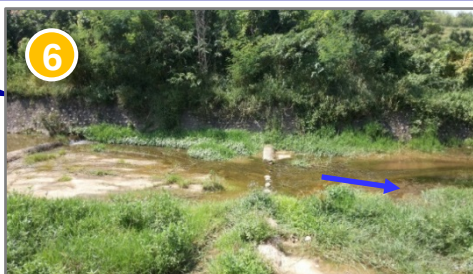
河床 植生茂密 ， 固床工老舊 破損，渠底 RC 亦有損壞情形
