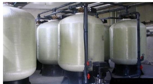
砂濾淨水設備
