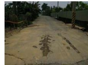
聖帕颱風中林村道路遭土石沖刷路面毀損
