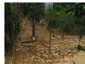
聖帕颱風台鳳洪水沿路邊側坡形成水道及土石沖刷
