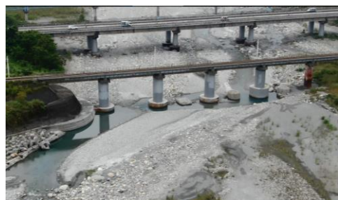
鐵路橋橋墩沖刷-木瓜溪鐵路橋
