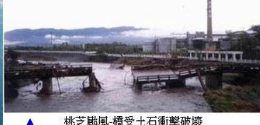
桃芝颱風-橋受土石衝擊破壞
