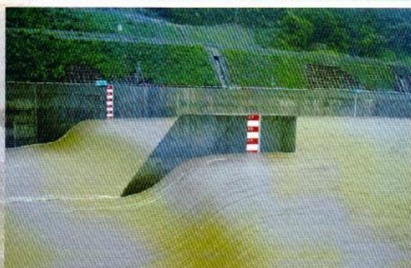
上：梳子型防砂壩 下：分洪道運作情形
