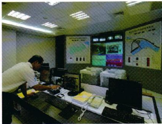
即時水位影像監控室
