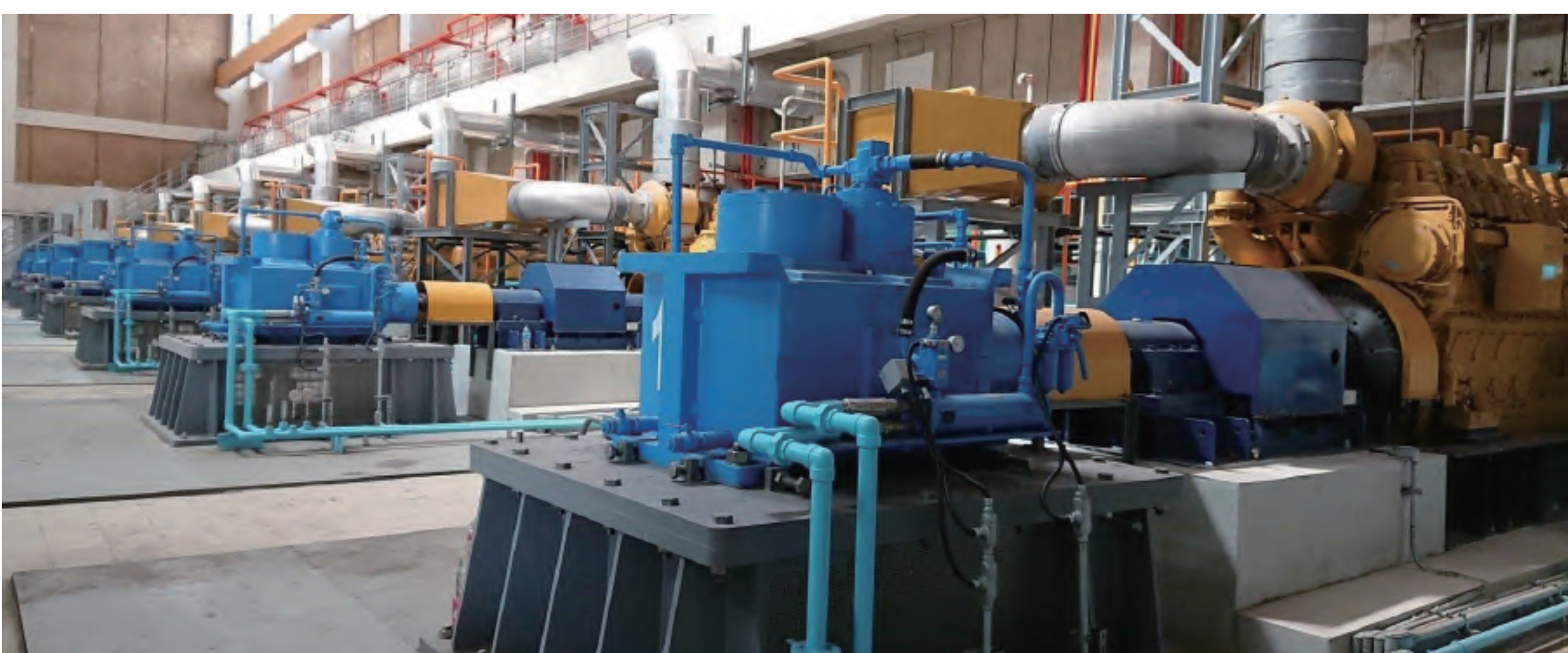
玉成抽水站內部抽水機組 資料來源:臺北市政府
