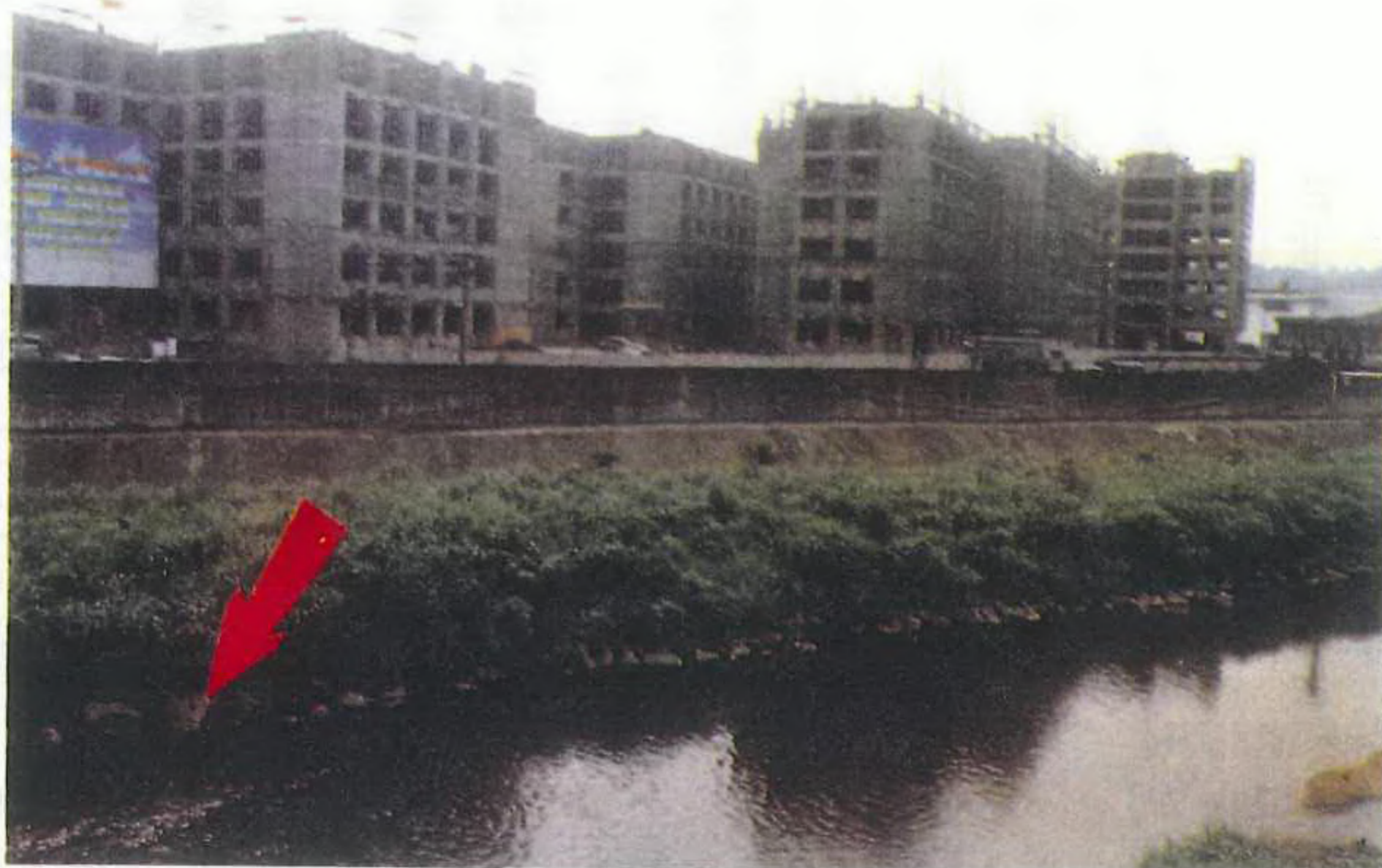
照25 景美溪寶橋左岸拋石基礎淘刷
