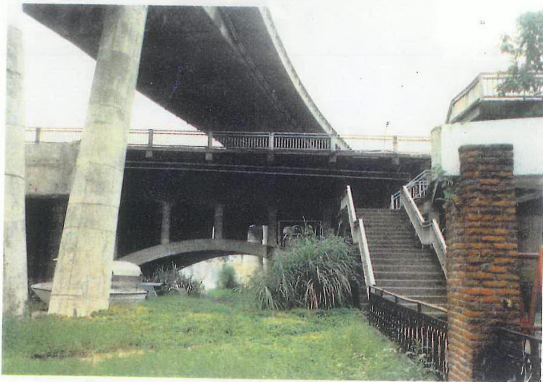
照11 基隆河中山橋右岸橋孔堵塞
