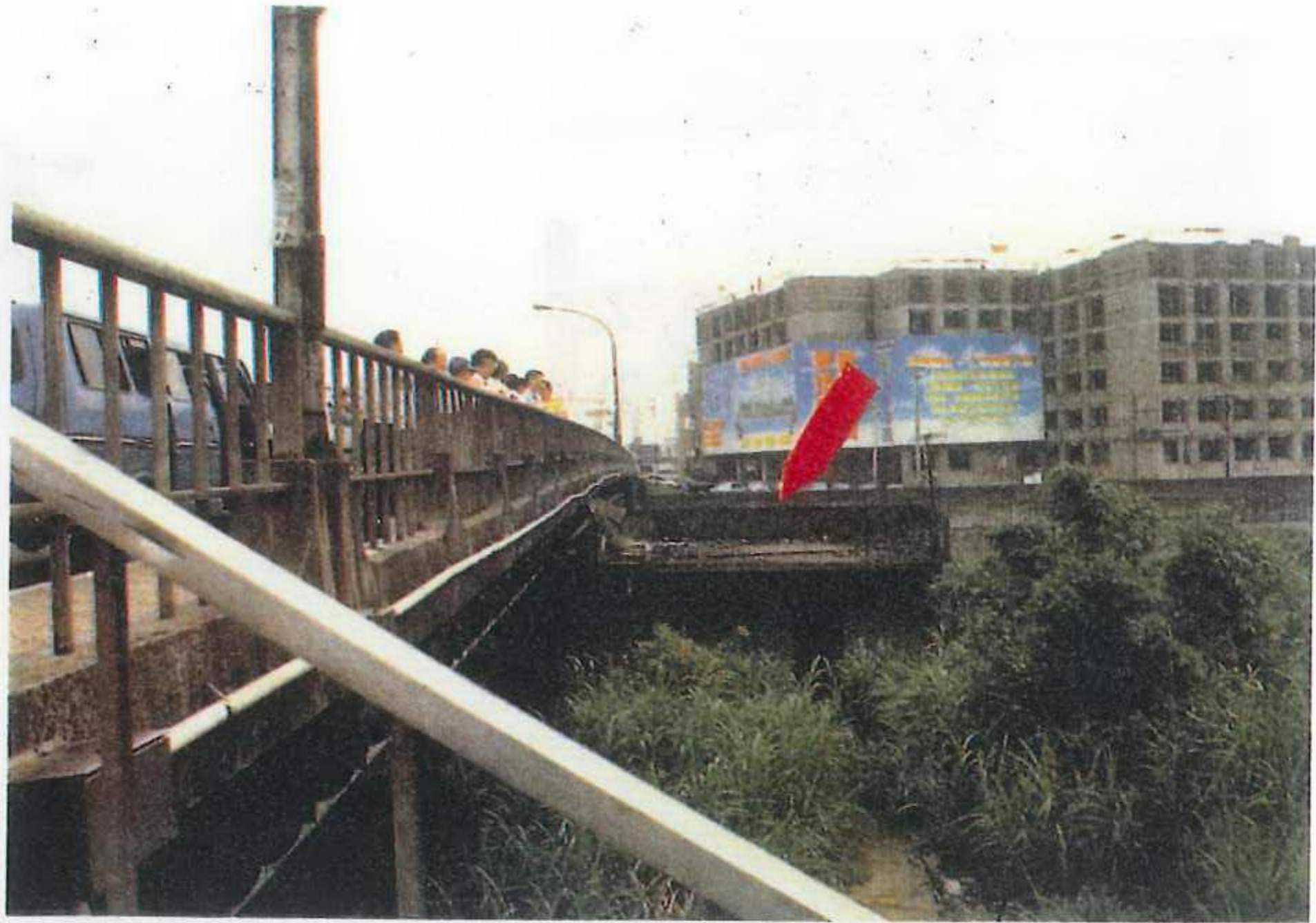
照 6 景美溪寶橋下違建
