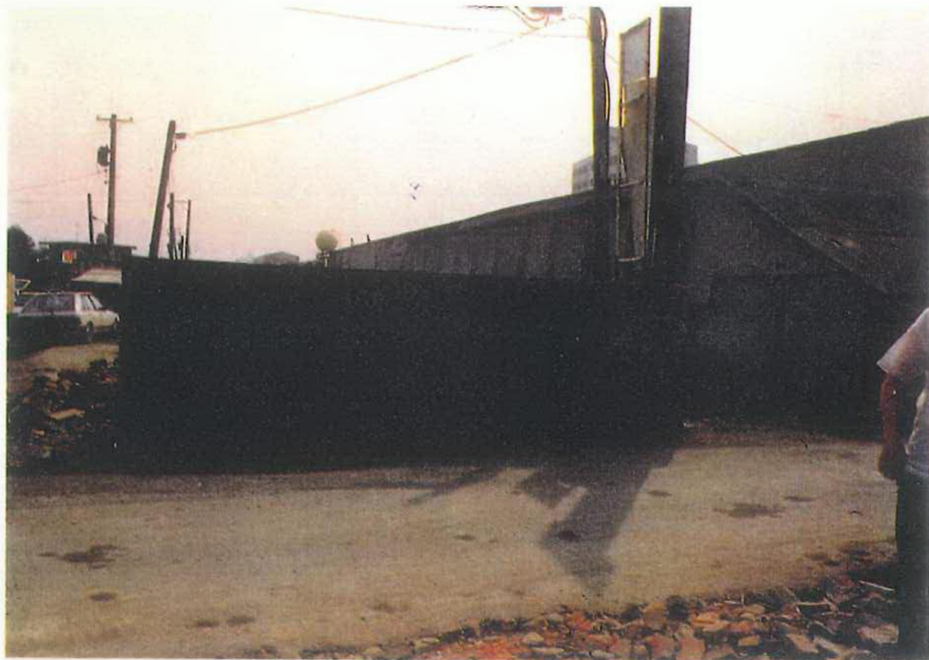
照23 撫遠擋水牆 2 號水門路坎高過閘門底
