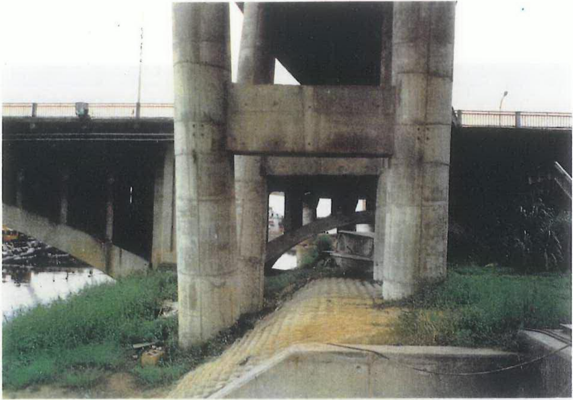
照13 基隆河中山橋上游橋墩堵塞
