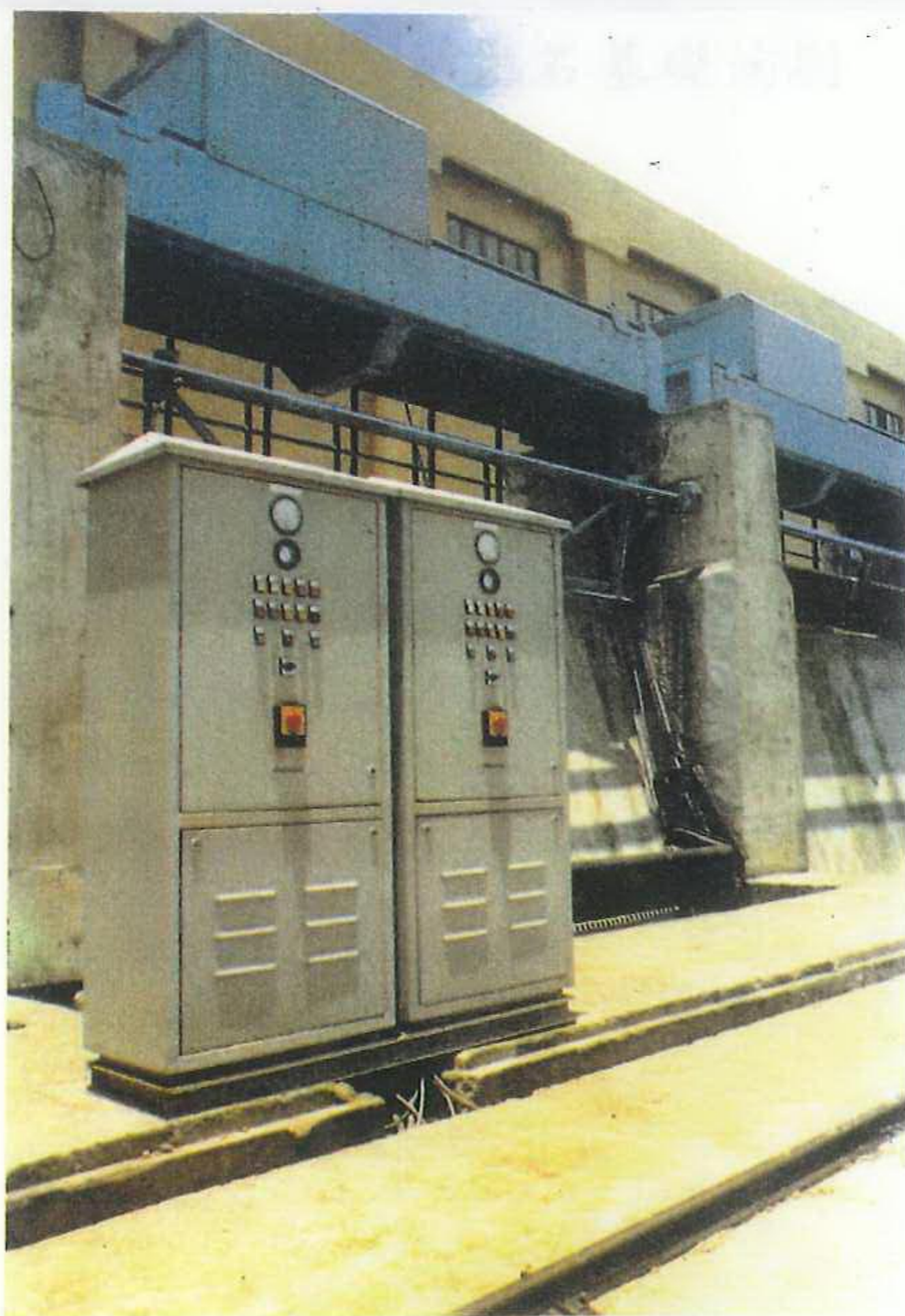
照24 抽水站開關箱暴露生銹
