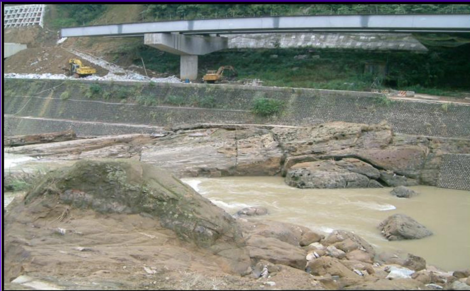
照片 鋼便橋下游河道大石塊
