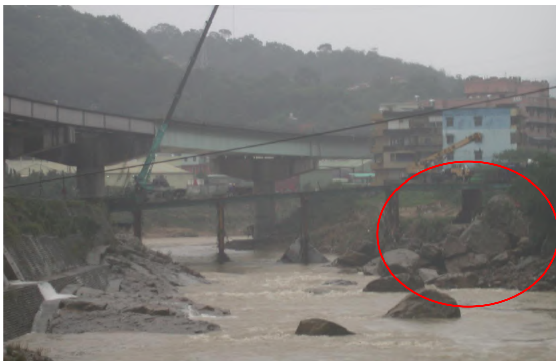
照片 4.5 鋼便橋下游河道束縮情形
