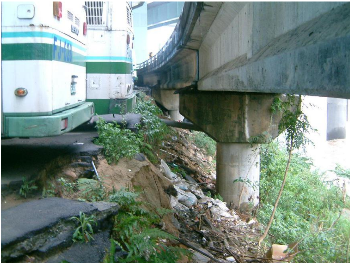
暖暖溪出口下游右岸河段遭沖蝕原有護岸崩塌情形
