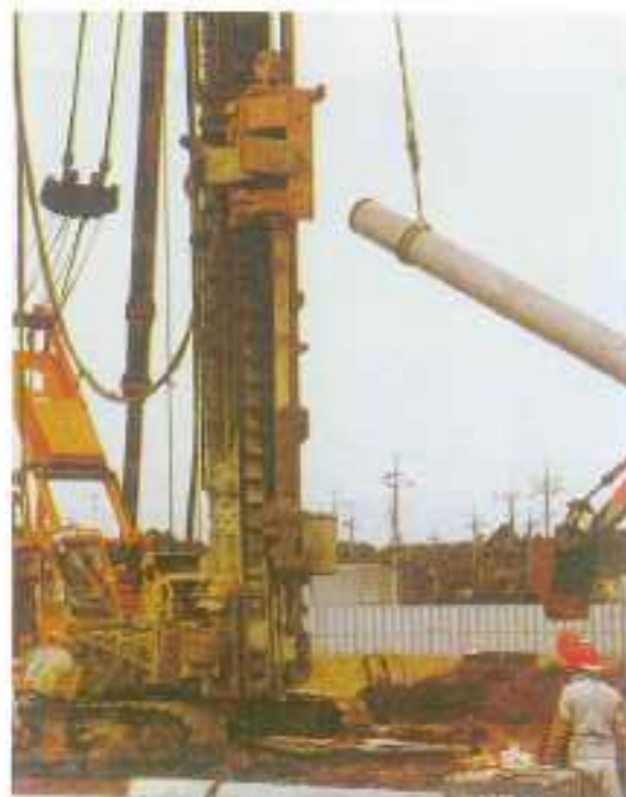
步驟② 右圖 樁孔鑽掘完成，吊放PC樁準備植入PC樁
