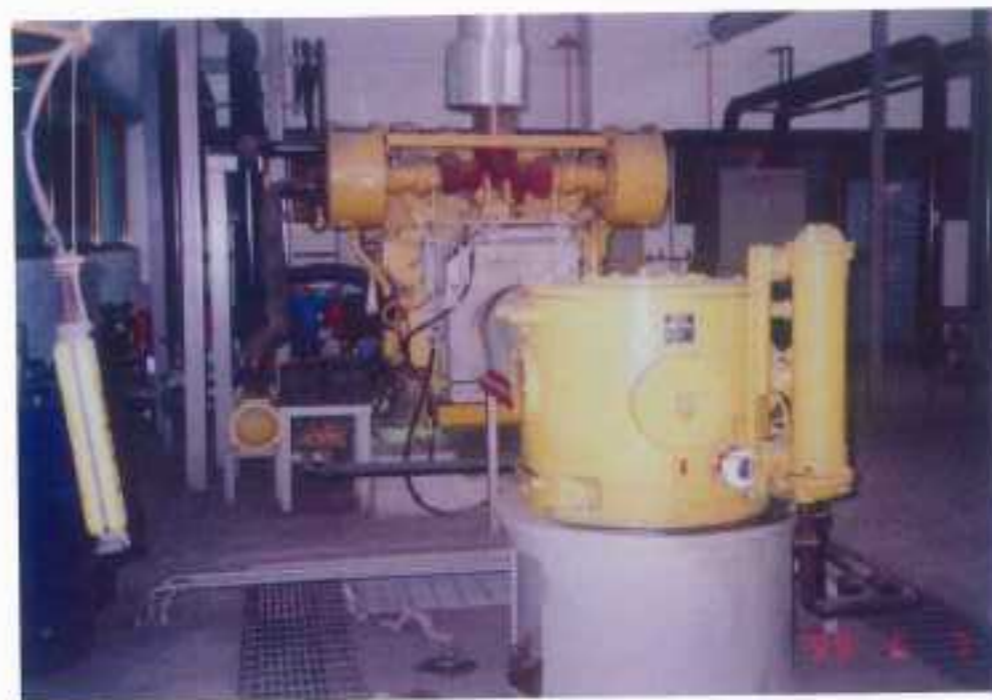
光復抽水站抽水機組
