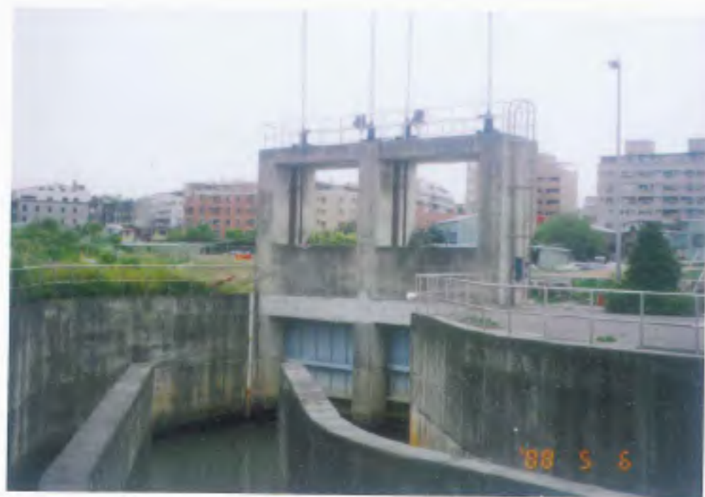
光復抽水站副閘門
