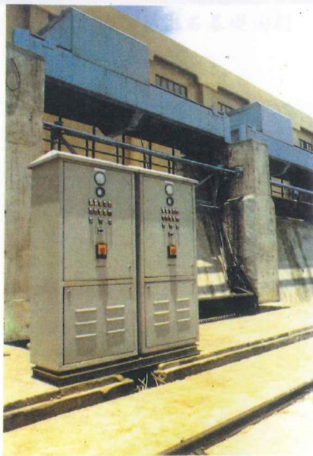
照24 抽水站開關箱暴露生銹
