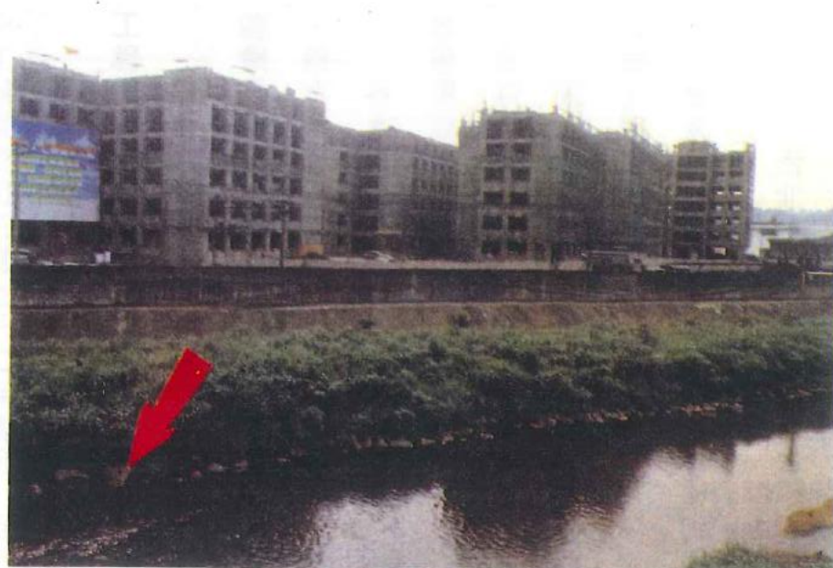
照25 景美溪寶橋左岸拋石基礎淘刷
