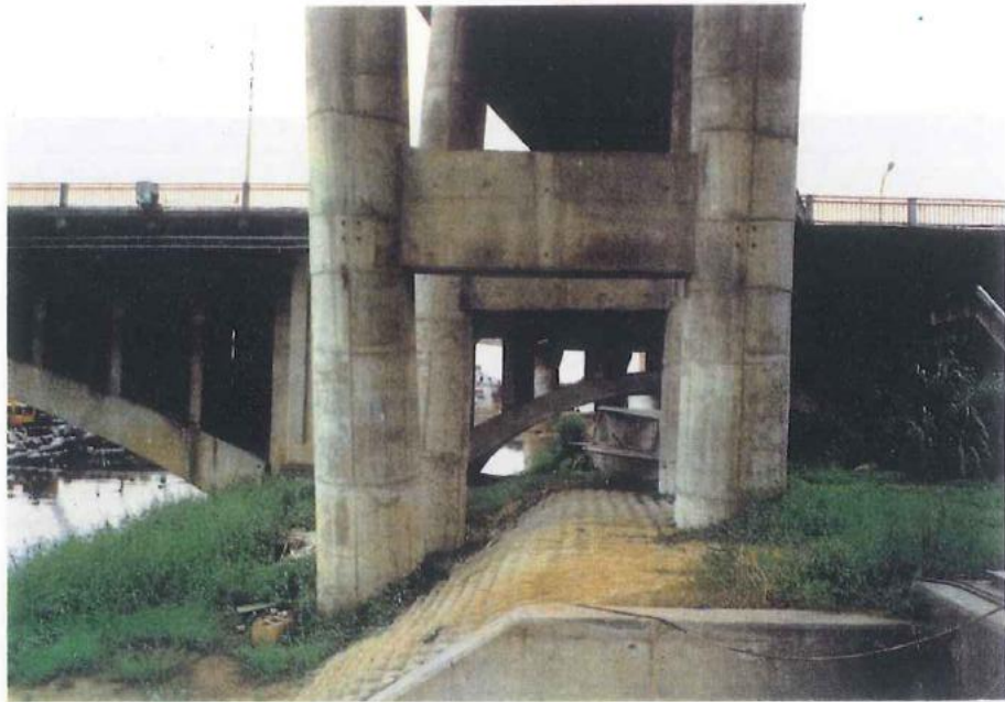
照13 基隆河中山橋上游橋墩堵塞
