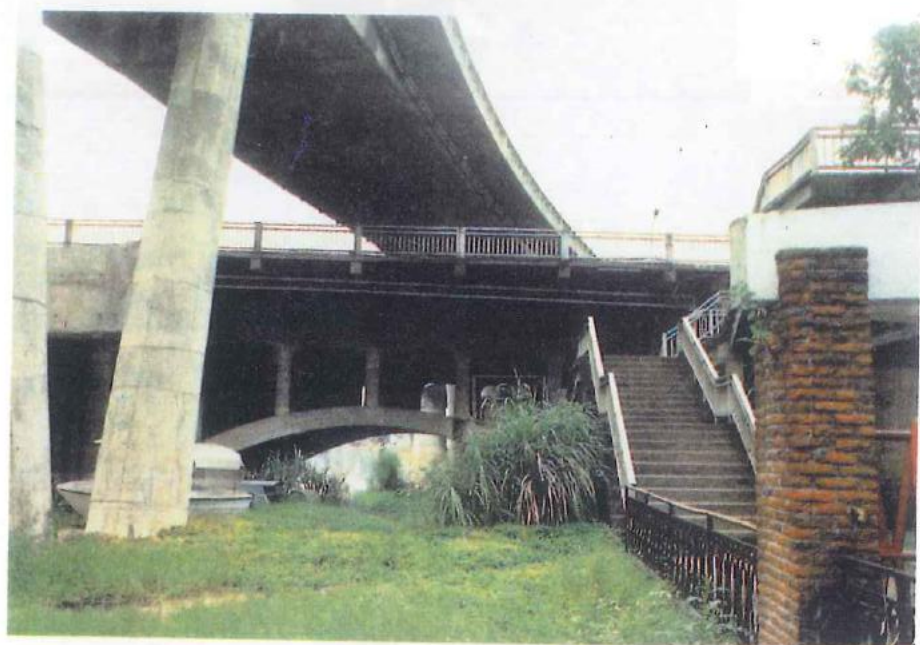
照11 基隆河中山橋右岸橋孔堵塞
