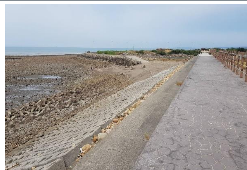
說明：堤頂步道毀損
