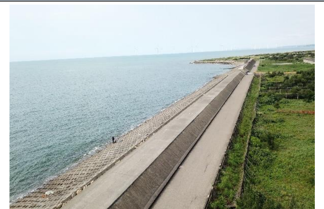
說明：海堤基礎拋石流失
