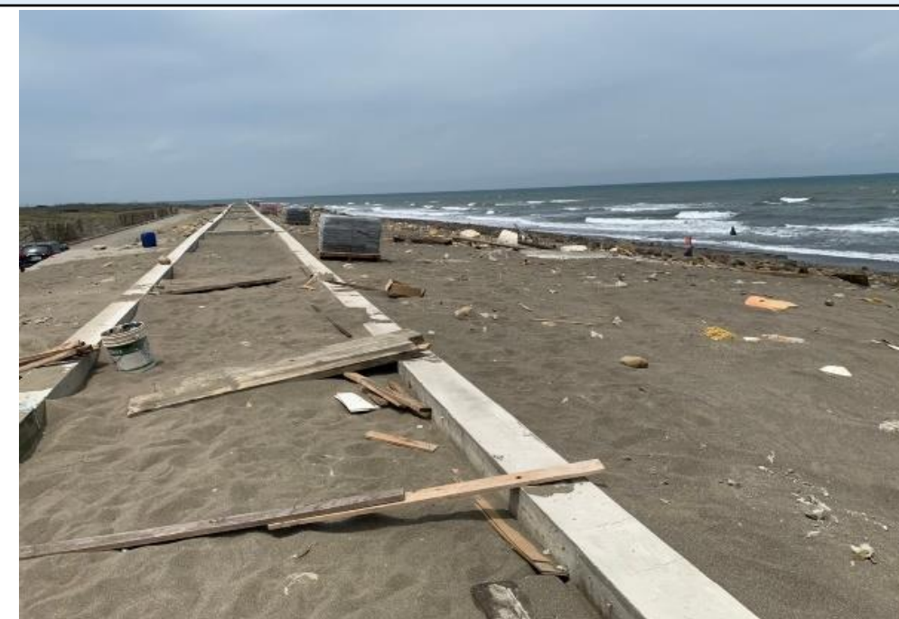
說明：堤防施工影響生物通行
