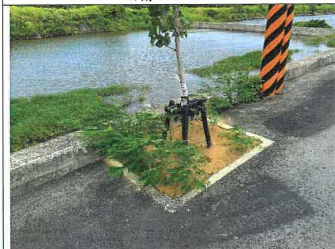
說明：多處植生槽已有銀合歡入侵。 日期：110/06/29
