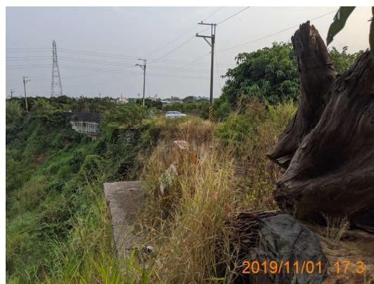
c.新化 A 工區因邊坡崩塌使上方道路斷裂
