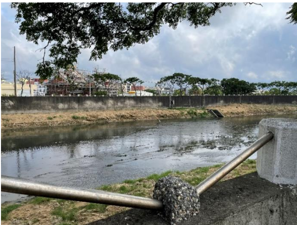
位置或樁號： 日期：110/5/18 說明：目前為水泥垂直堤防。
