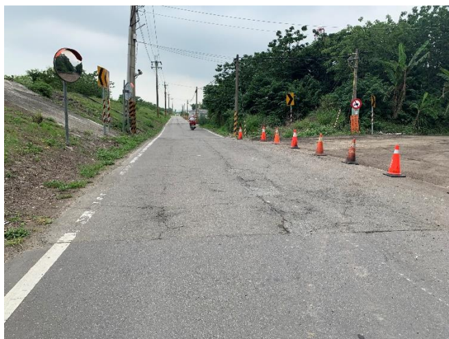
位置或樁號： 日期：110 年 5 月 18 日 說明：芎林堤防水防道路路面破損嚴重
