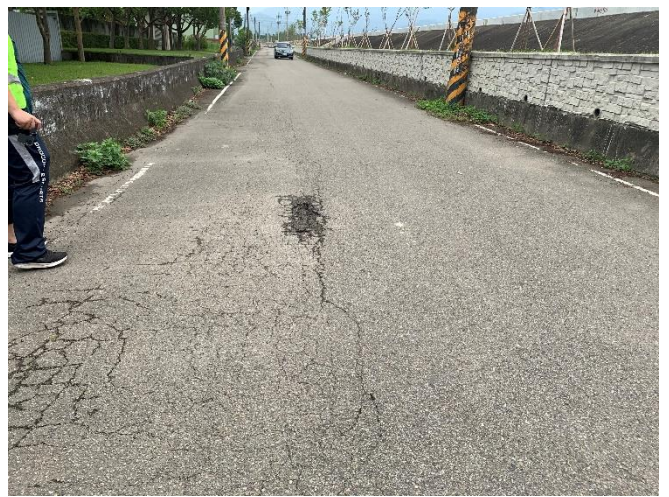
位置或樁號： 日期：110 年 5 月 18 日 說明：山豬湖堤防水防道路路面破損
