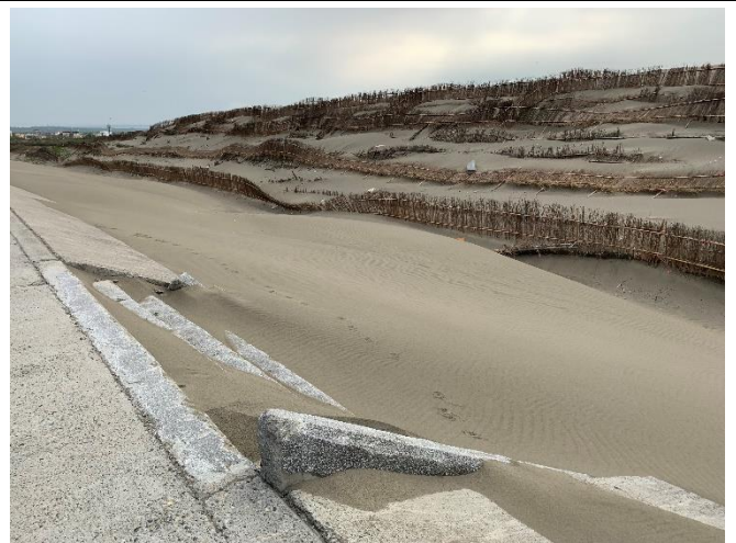
位置或樁號： 日期：110/11/3 說明：部分堤防道路已被風吹沙淹沒
