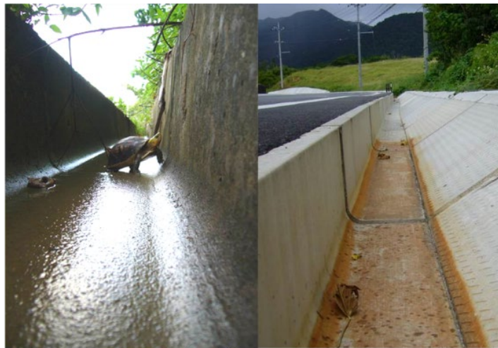
圖 4.7-3 側溝緩坡化可幫助動物較容易逃脫。
