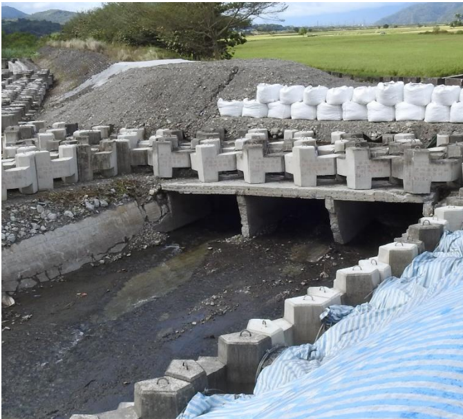
圖七 箱涵整修應一併確認水生生物的廊道功能
