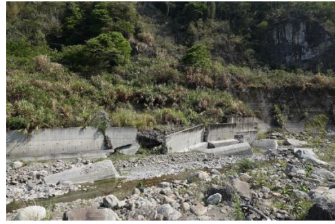
達德安壩旁左岸邊坡沖蝕情形 (112.4.11)
