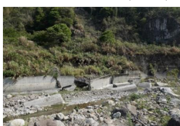
169 線道基腳崩壞(112.4)
