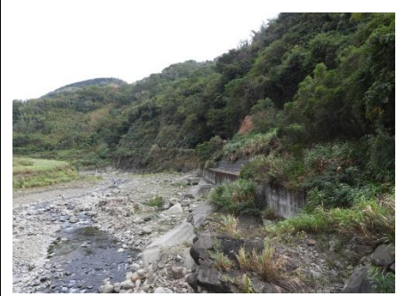
達德安壩上游左岸邊坡沖蝕
