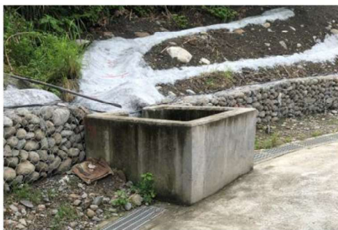
① 工區內既有集水井開口開放
