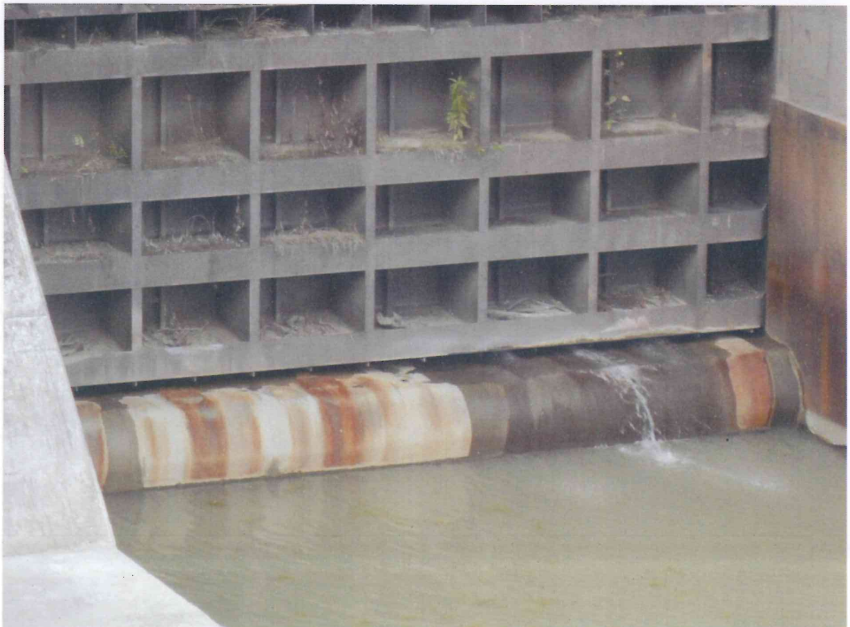
附圖二、2號排砂道堰頂滲漏情形
