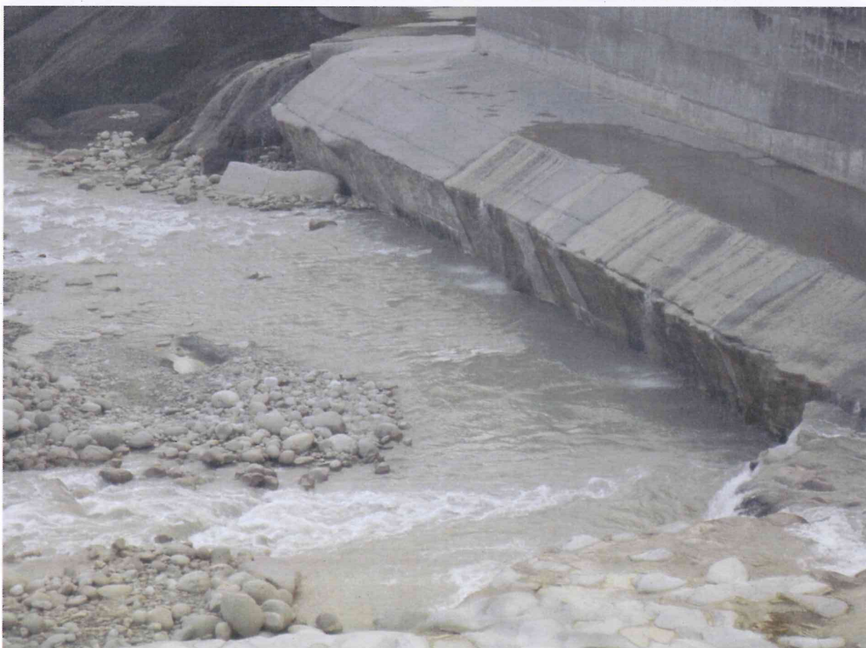
附圖六、防洪牆護坦河床刷深約 3~4 公尺情形
