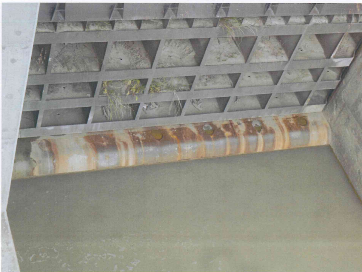
附圖四、1 號排砂道堰頂灌漿孔蓋脫落情形
