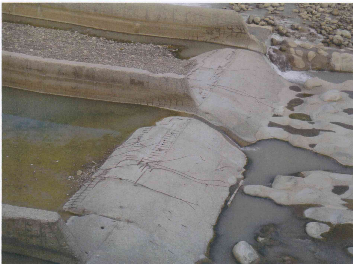
附圖五、2 號及 3 號排砂道下游導流牆及尾檻混凝土磨耗及鋼筋裸露
