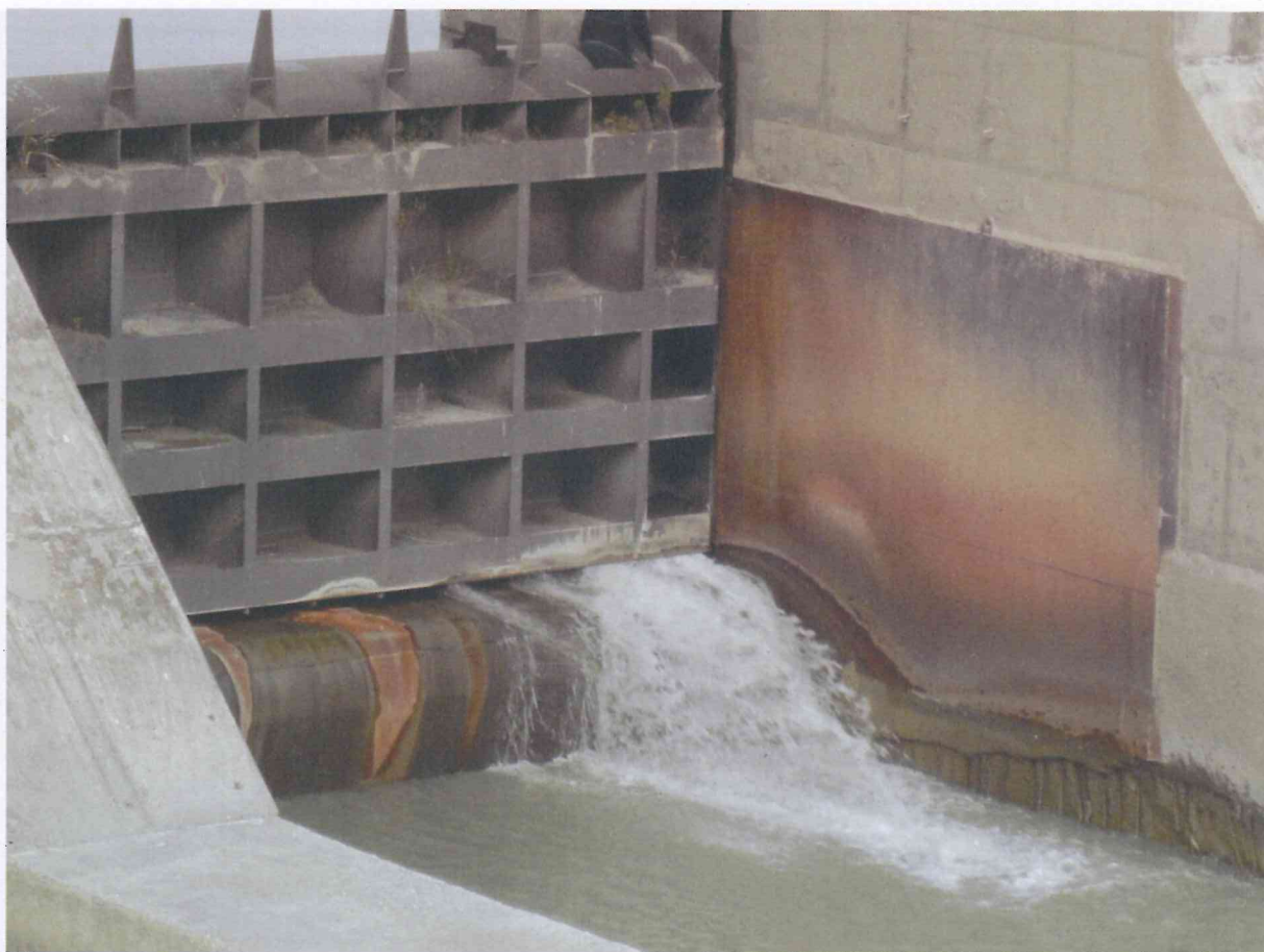
附圖三、3 號排砂道堰頂滲漏情形
