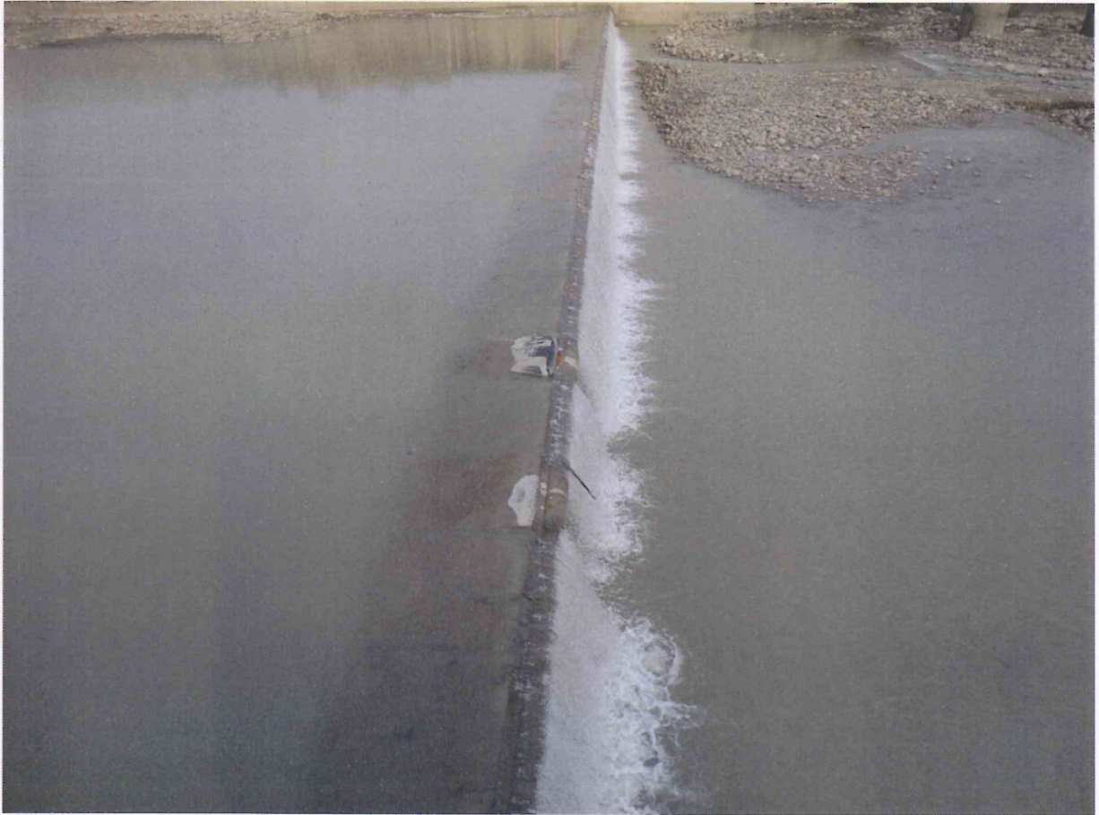
附圖一、橡皮墊隆起及落水池淤積情形
