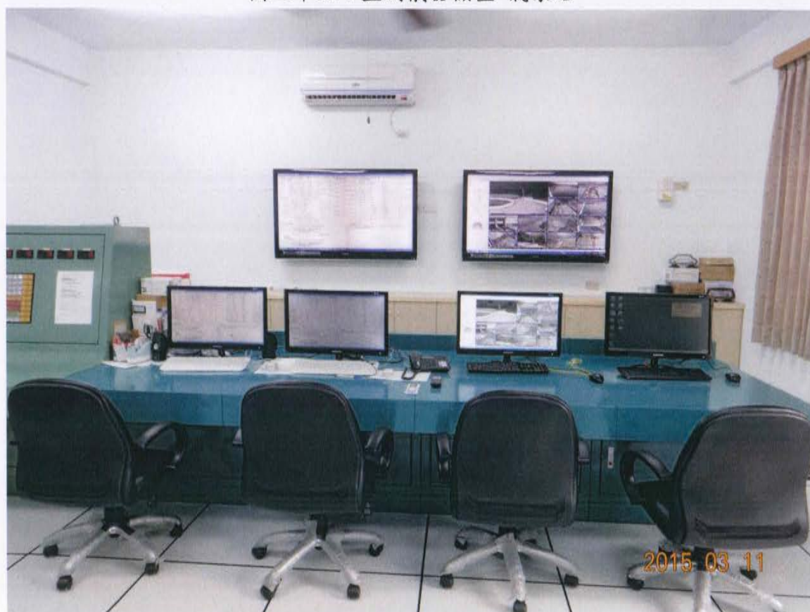
圖二十六：監測儀器檢查-控制室監控主機
