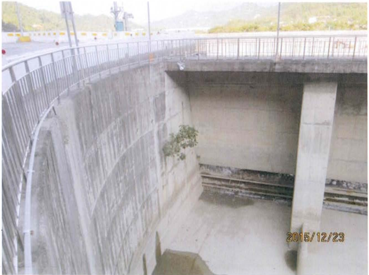
圖六:取水口混凝土結構伸縮縫長植物
