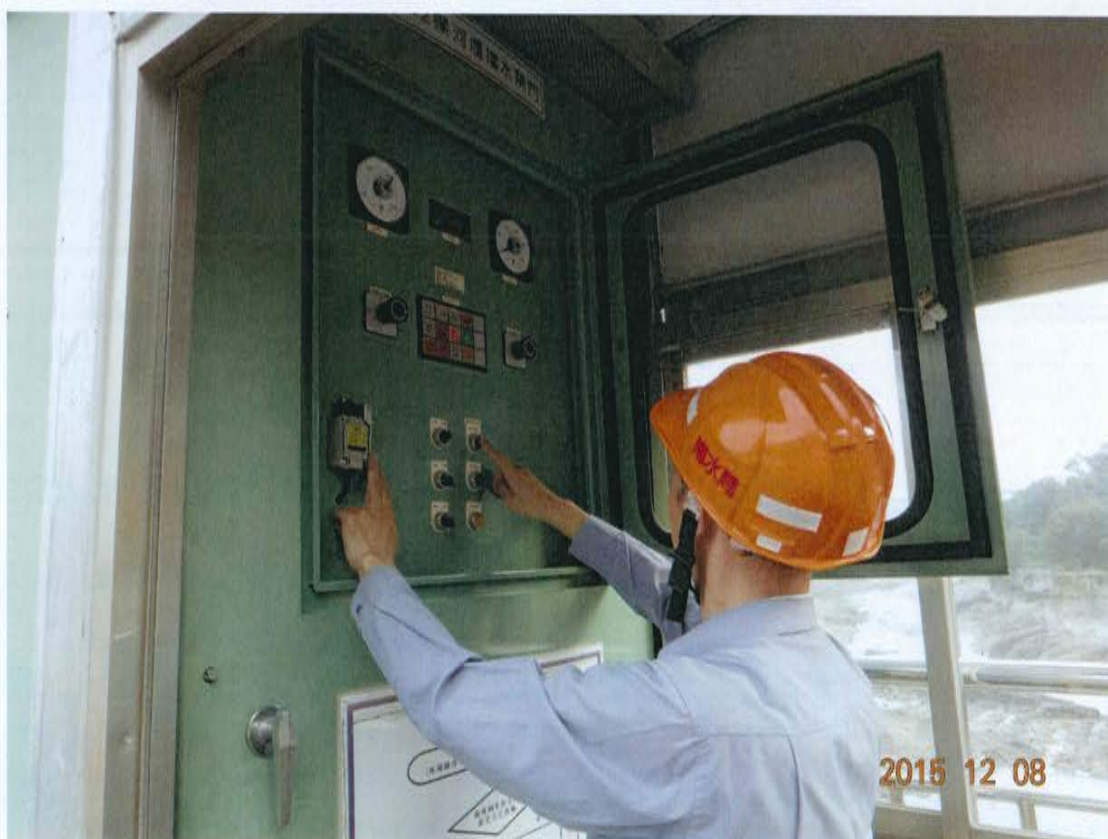
圖十二：排砂道擋水閘門-控制箱電源及運轉檢查
