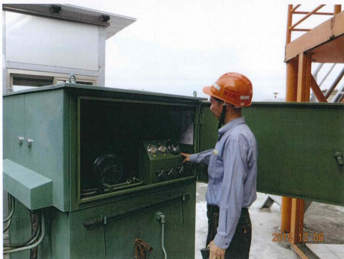
圖十六：取水口排砂閘門-電源及油壓設備運轉檢查
