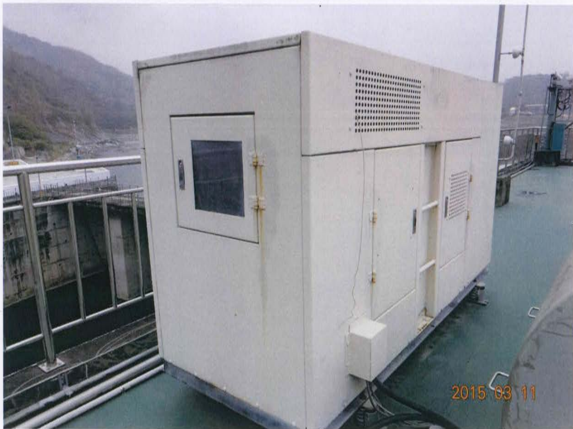
圖二十二：備援緊急發電機(60KW)檢查
