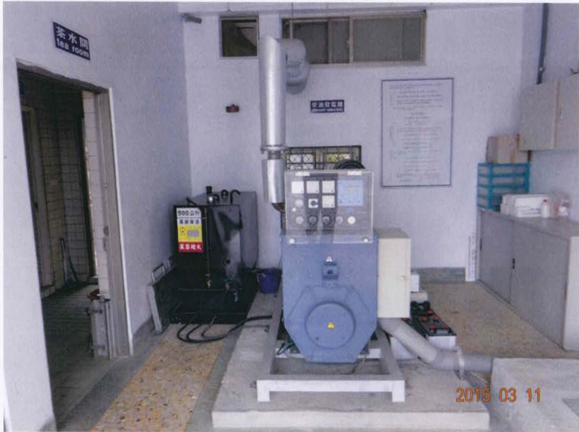
圖二十一：控制室緊急發電機(125KW)檢查
