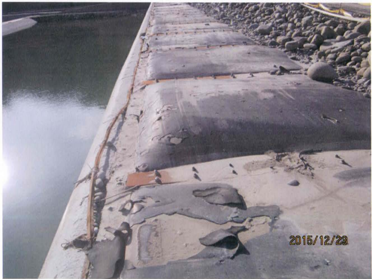
圖三:前沿鐵條翹起，部分區塊內部淤砂而隆起
