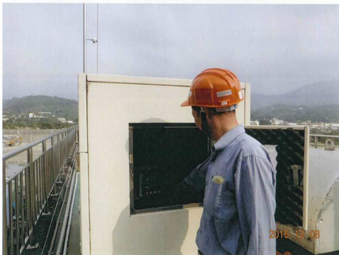
圖二十二：備援緊急發電機(60KW)檢查
