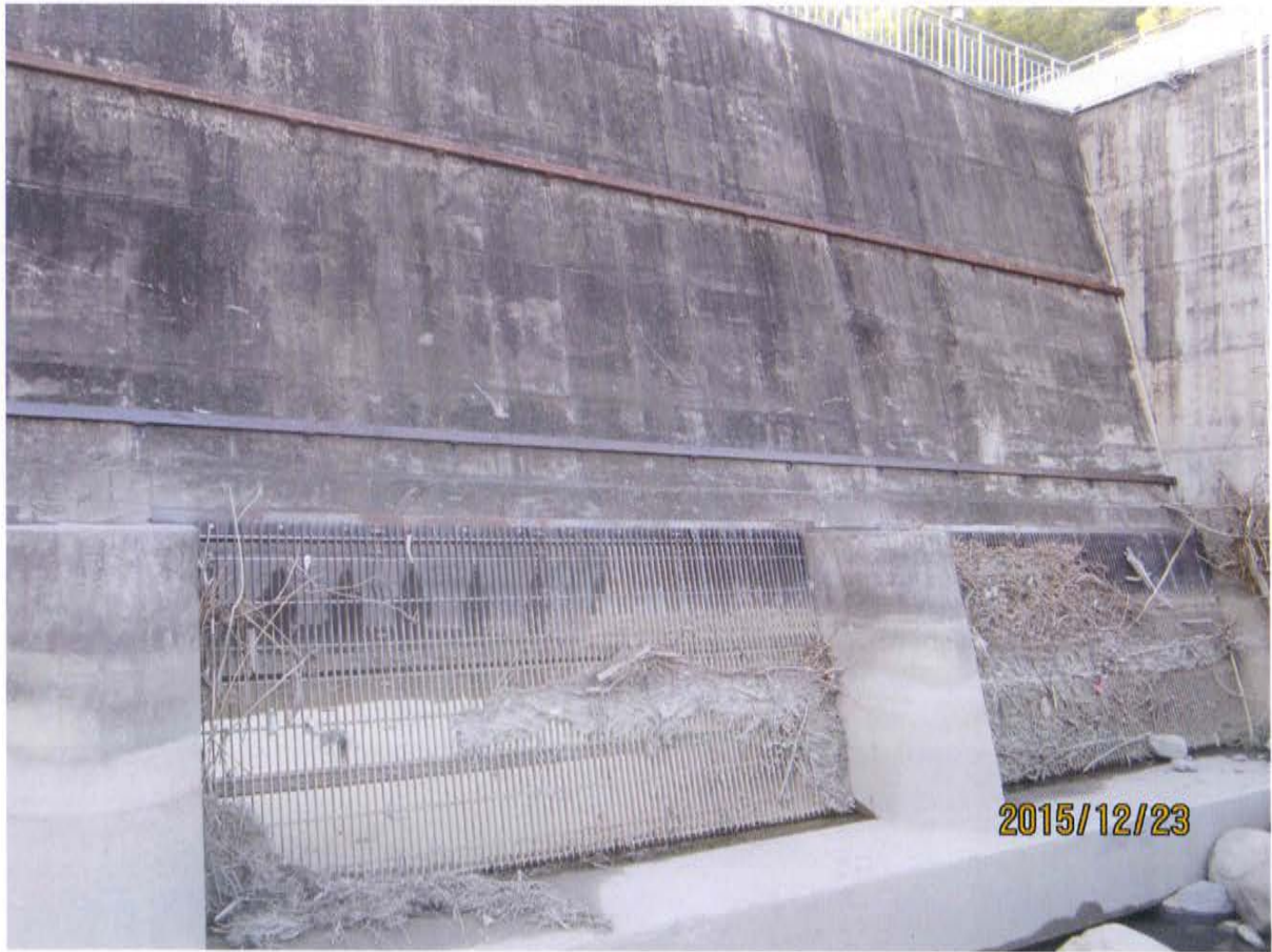
圖七:取水口攔污柵雜物阻塞
