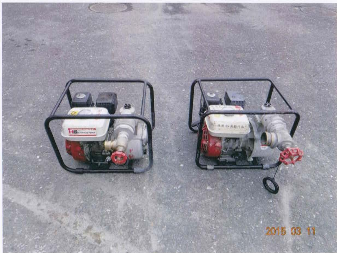
圖二十八：移動式抽水機運轉檢查
