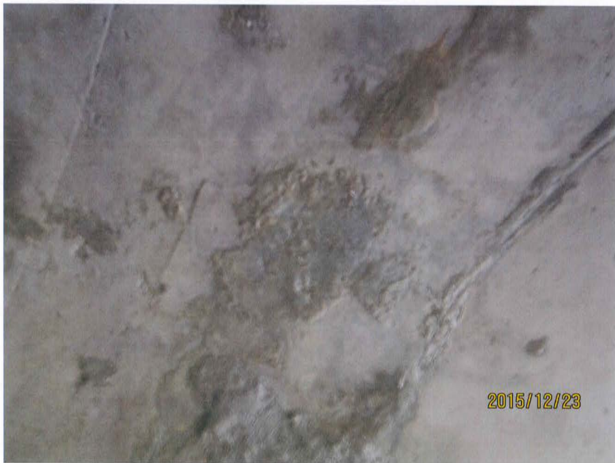
圖九：隧道結構混凝土表面蜂窩、滲漏水
