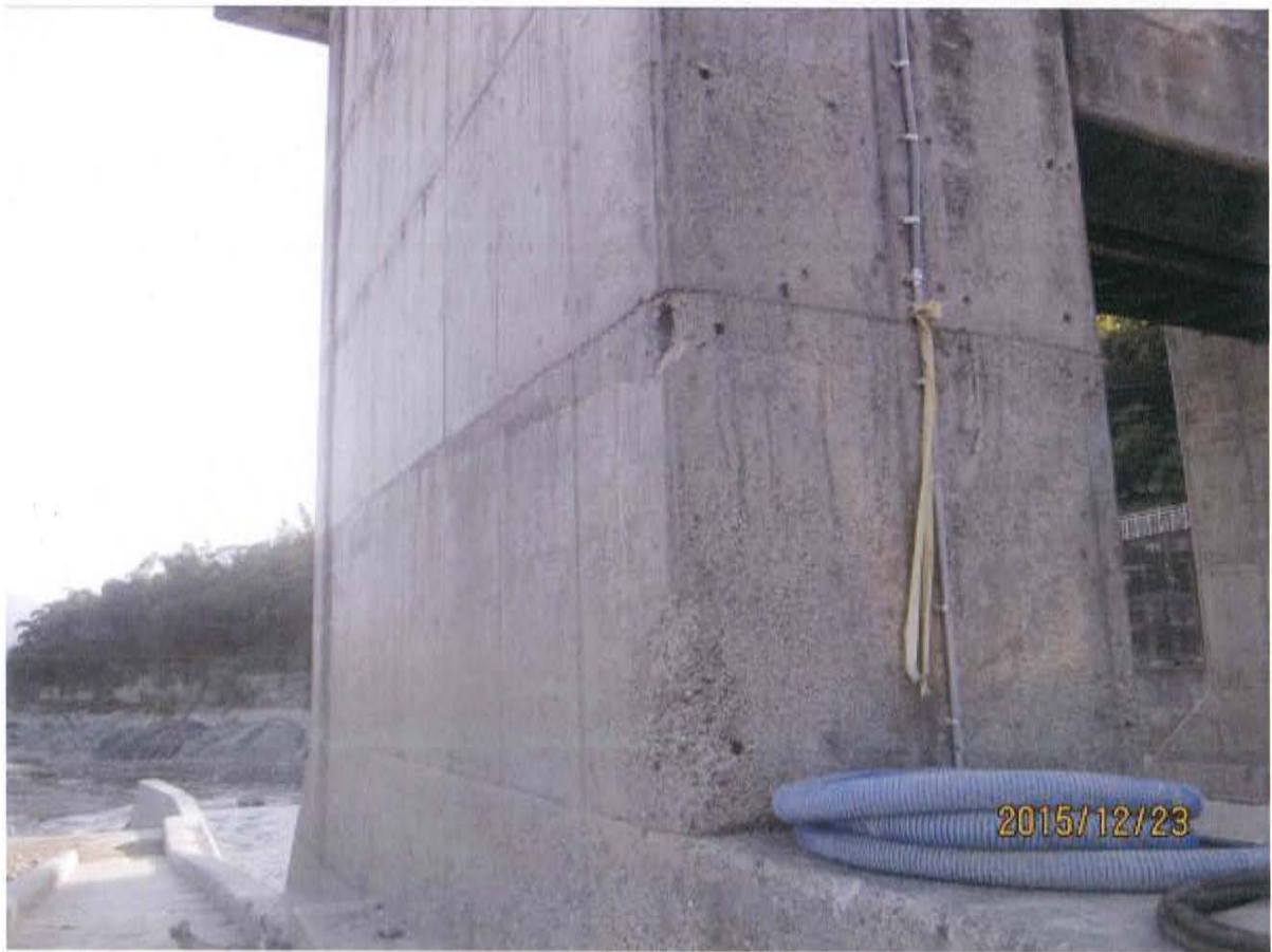
圖五:排砂道操作橋橋墩磨耗、穴蝕
