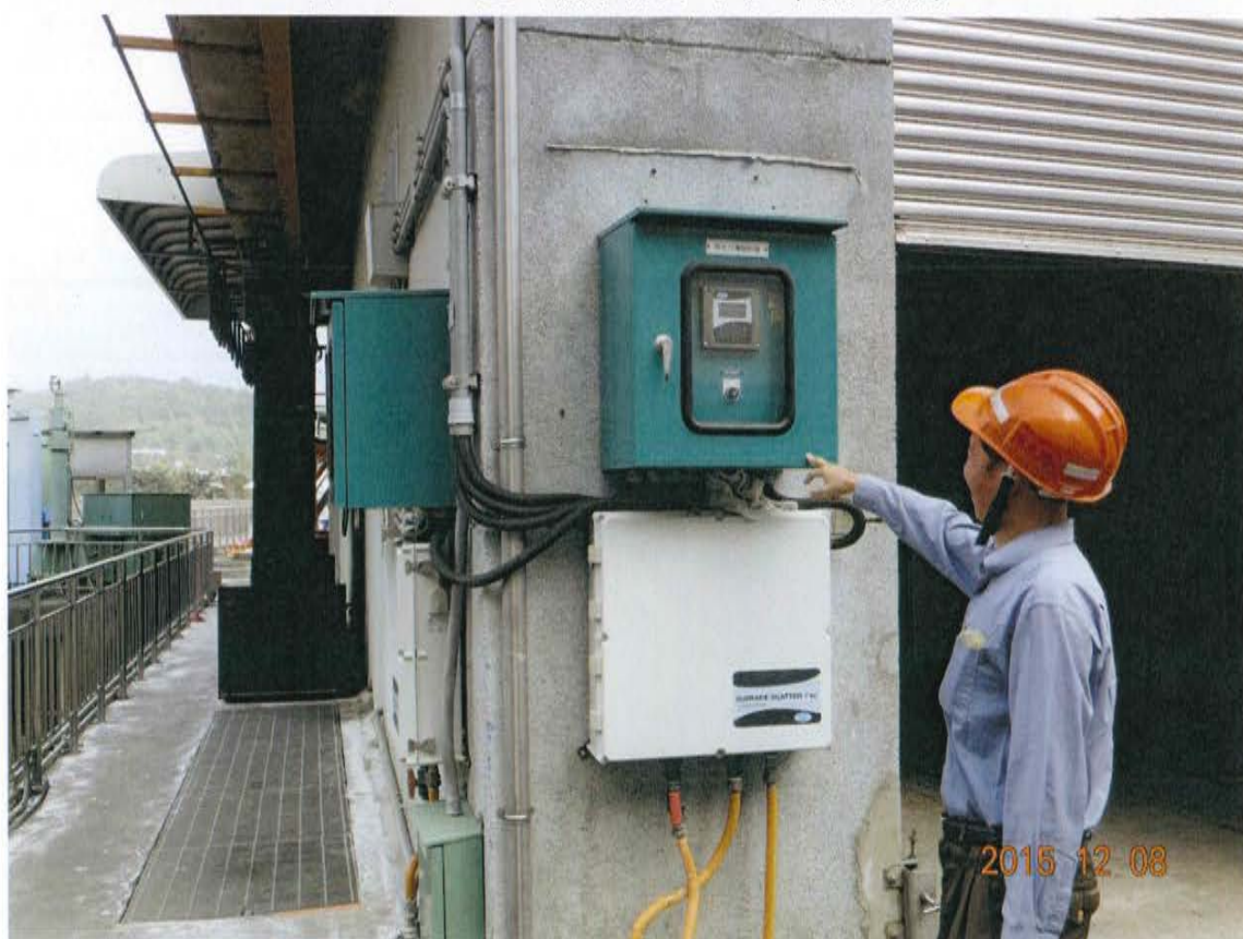
圖二十四：監測儀器檢查-濁度計
