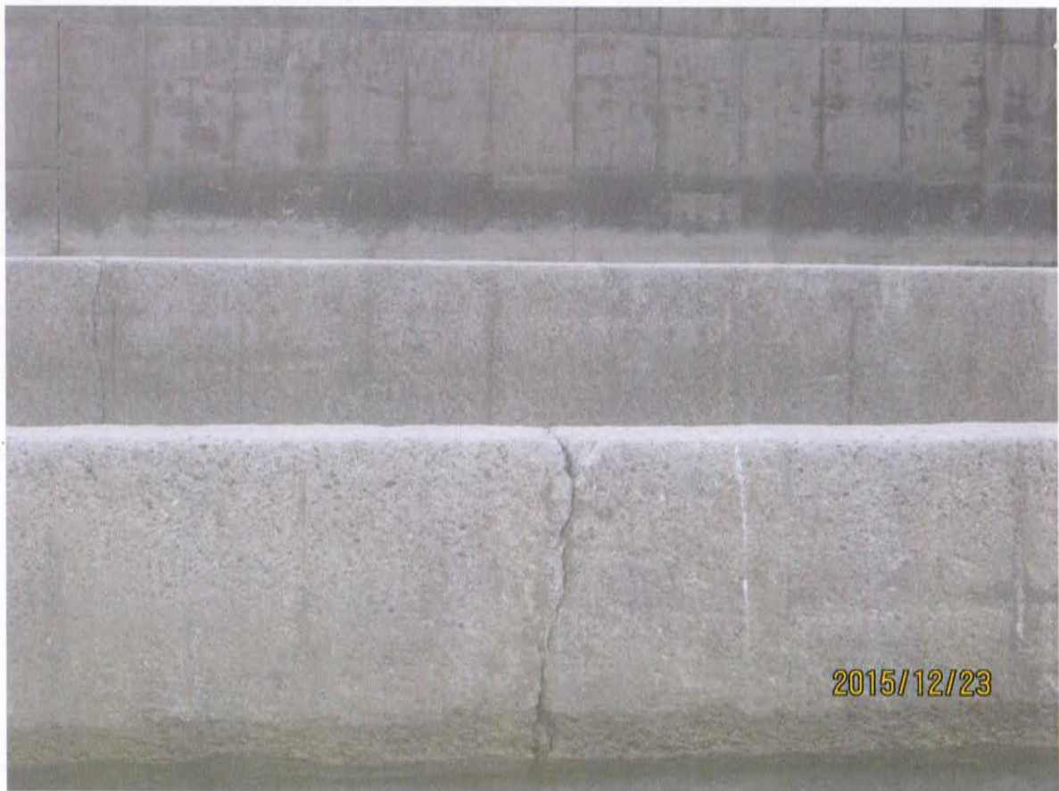
圖四:排砂道導流牆伸縮縫磨耗
