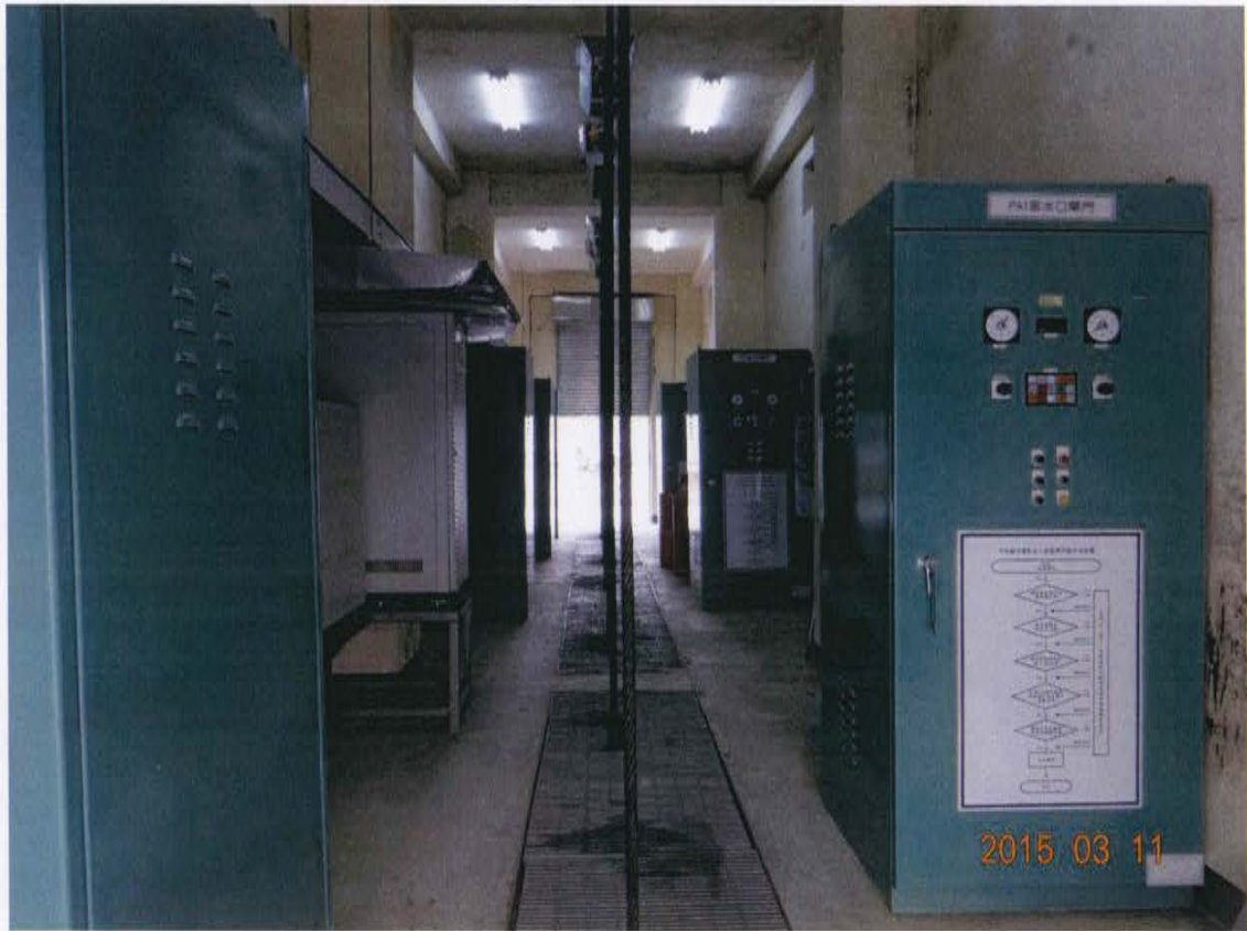
圖十三：取水口控制閘門-控制箱電源檢查
