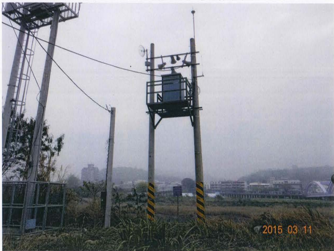
圖二十：放水警報廣播系統-甲仙橋站設備檢查
