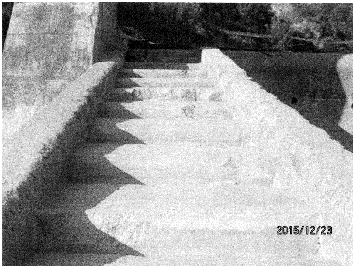
圖十：魚道階梯混凝土剝落磨損
