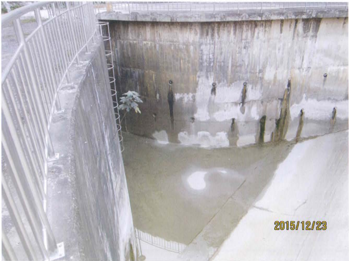
圖八:沉砂池壁面混凝土伸縮縫長植物
