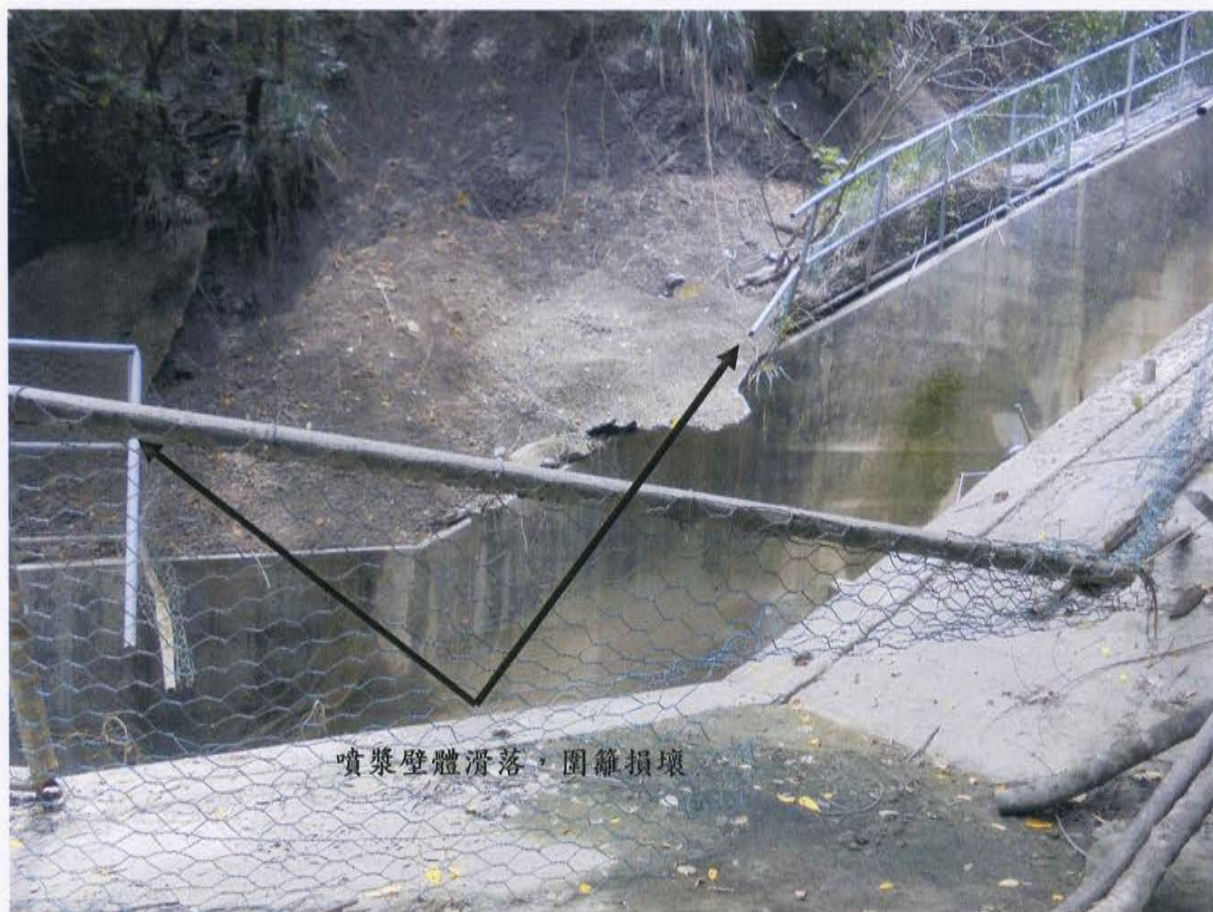
圖七:引水隧道出口洩槽 3 號靜水池右側噴漿壁體滑落，造成圍籬損壞左右各約 20 公尺
