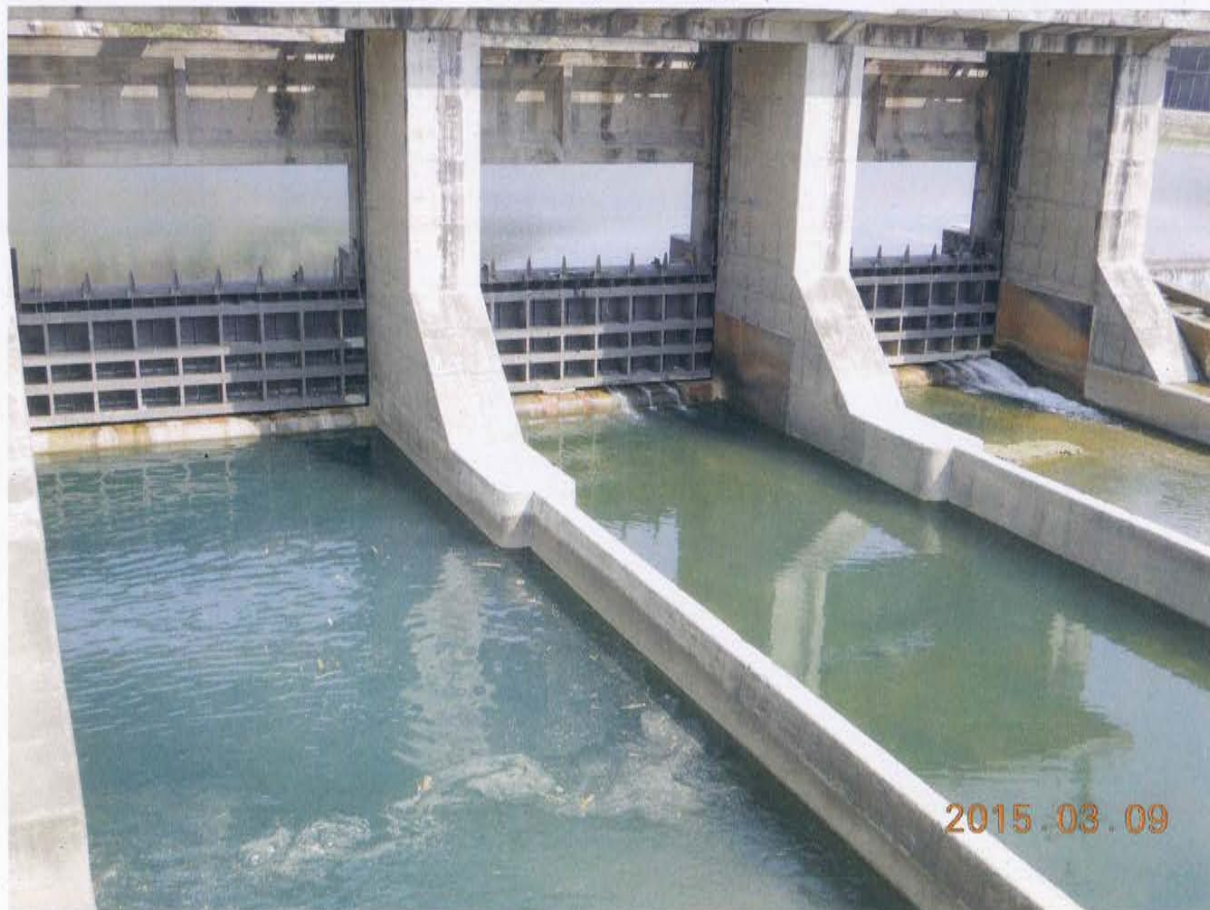
圖二：#1 灌漿孔蓋脫落，#2、#3 鋼板磨蝕滲水，預計 104 年 3 月發包修復
