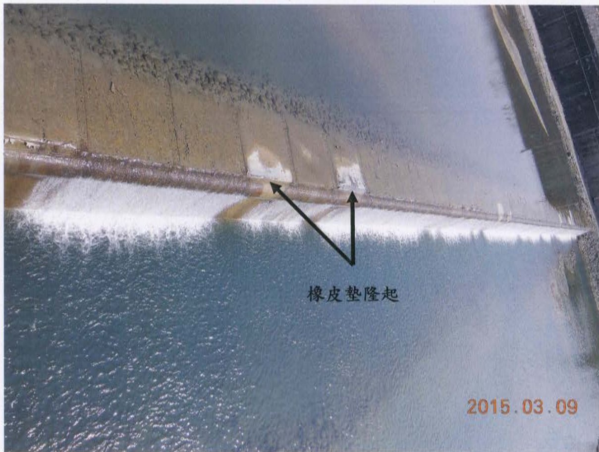
圖一：堰頂混凝土受鋼板及橡膠墊保護，狀況良好，惟部分橡皮墊因內部淤砂而隆起，擬於下游端開口讓淤砂排出
