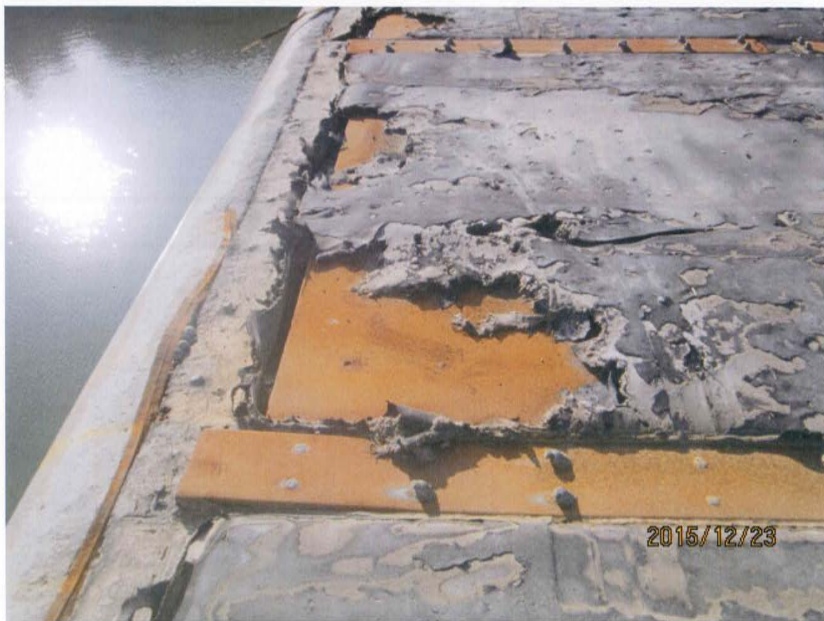
圖二：堰頂混凝土受鋼板及橡膠墊保護，狀況良好，惟部分橡皮墊破損，鋼板外露前移
