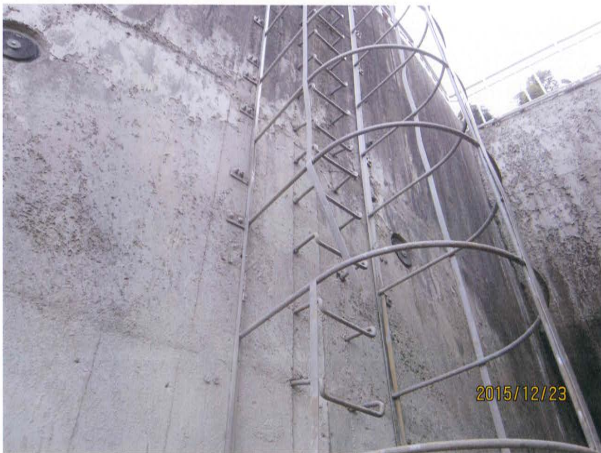
圖八續：沉砂池爬梯保護龍部分鐵條斷開
