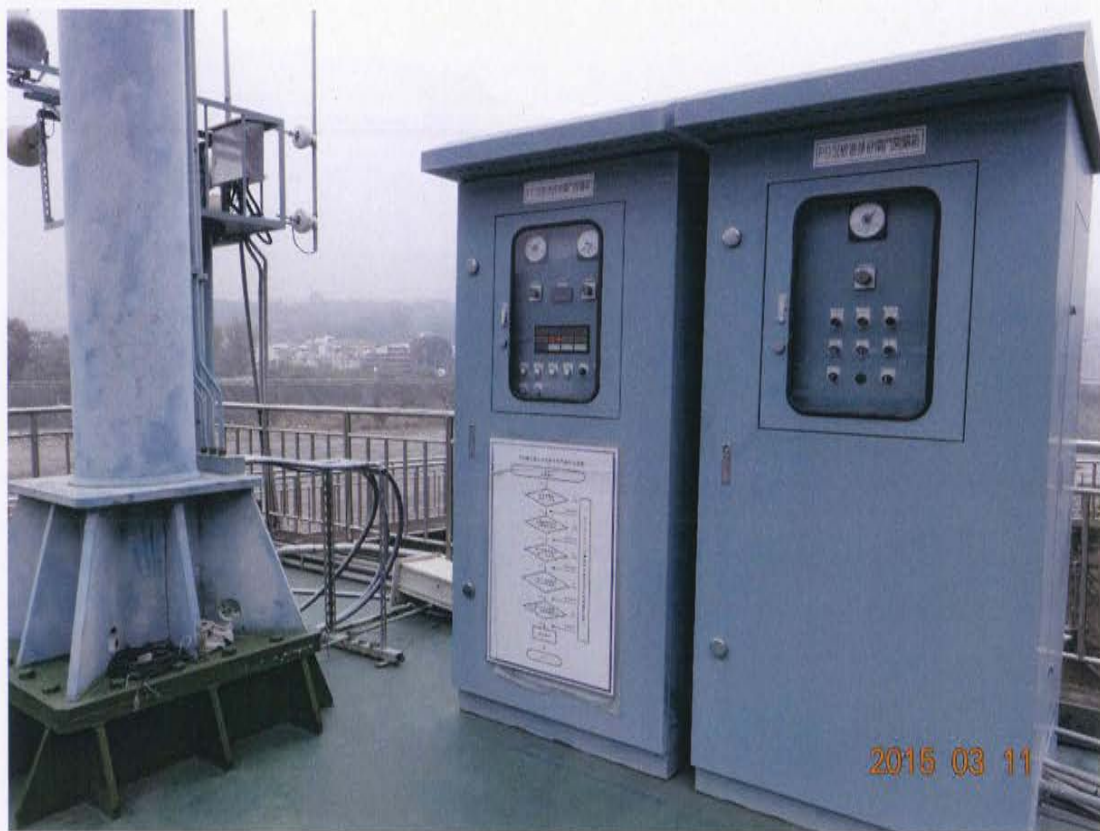
圖十七：取水口沉沙池排砂閘門-電源及油壓馬達運轉檢查
