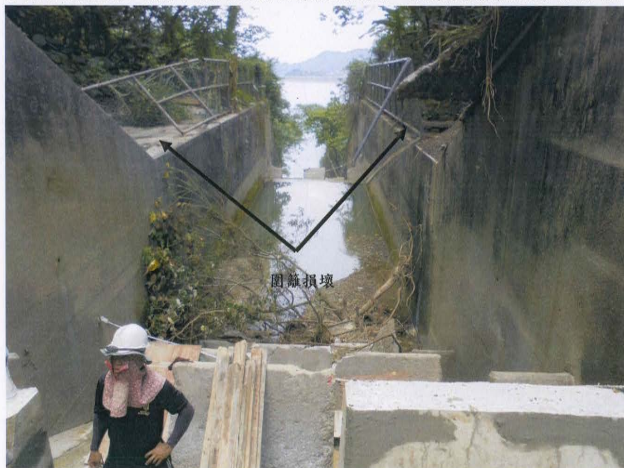
圖八:引水隧道出口洩槽 3 號靜水池右側噴漿壁體滑落，造成圍籬損壞左右各約 20 公尺
