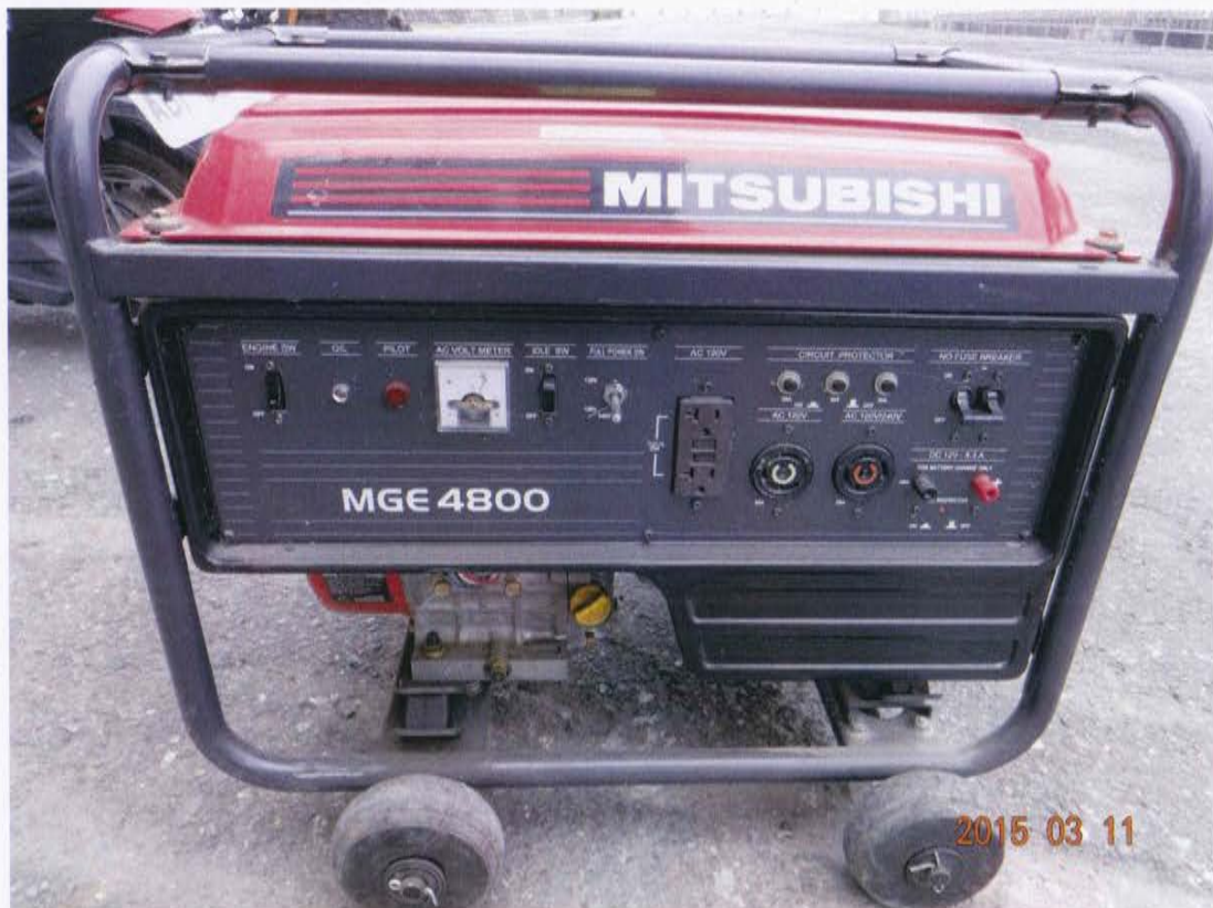
圖二十七：移動式發電機運轉檢查
