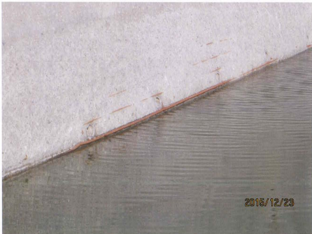
圖一：堰體混凝土接部分區段鋼筋裸露鏽蝕
