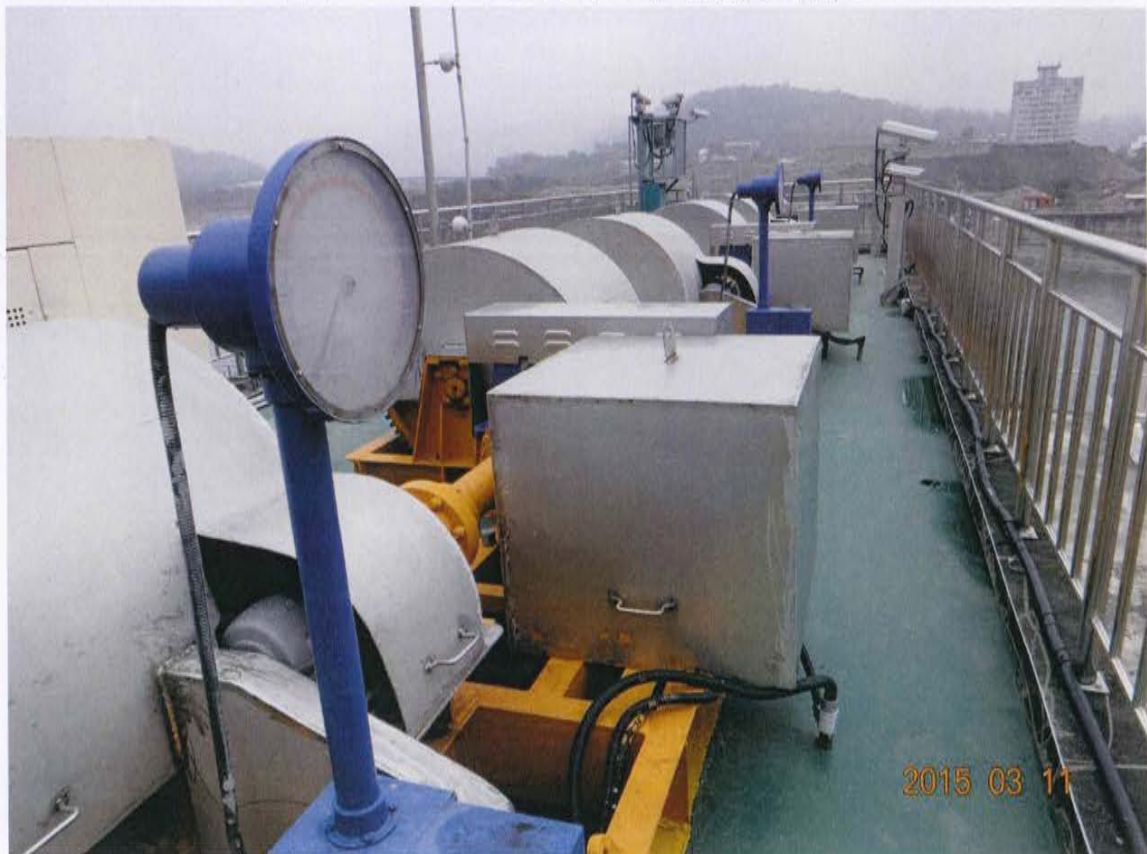
圖十四：取水口控制閘門-外觀及齒輪箱油位檢查
