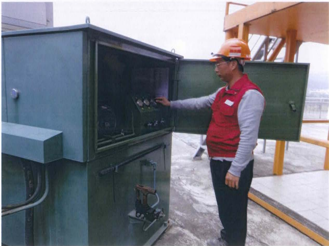
圖三十：取水口排砂閘門-油壓運轉檢查
