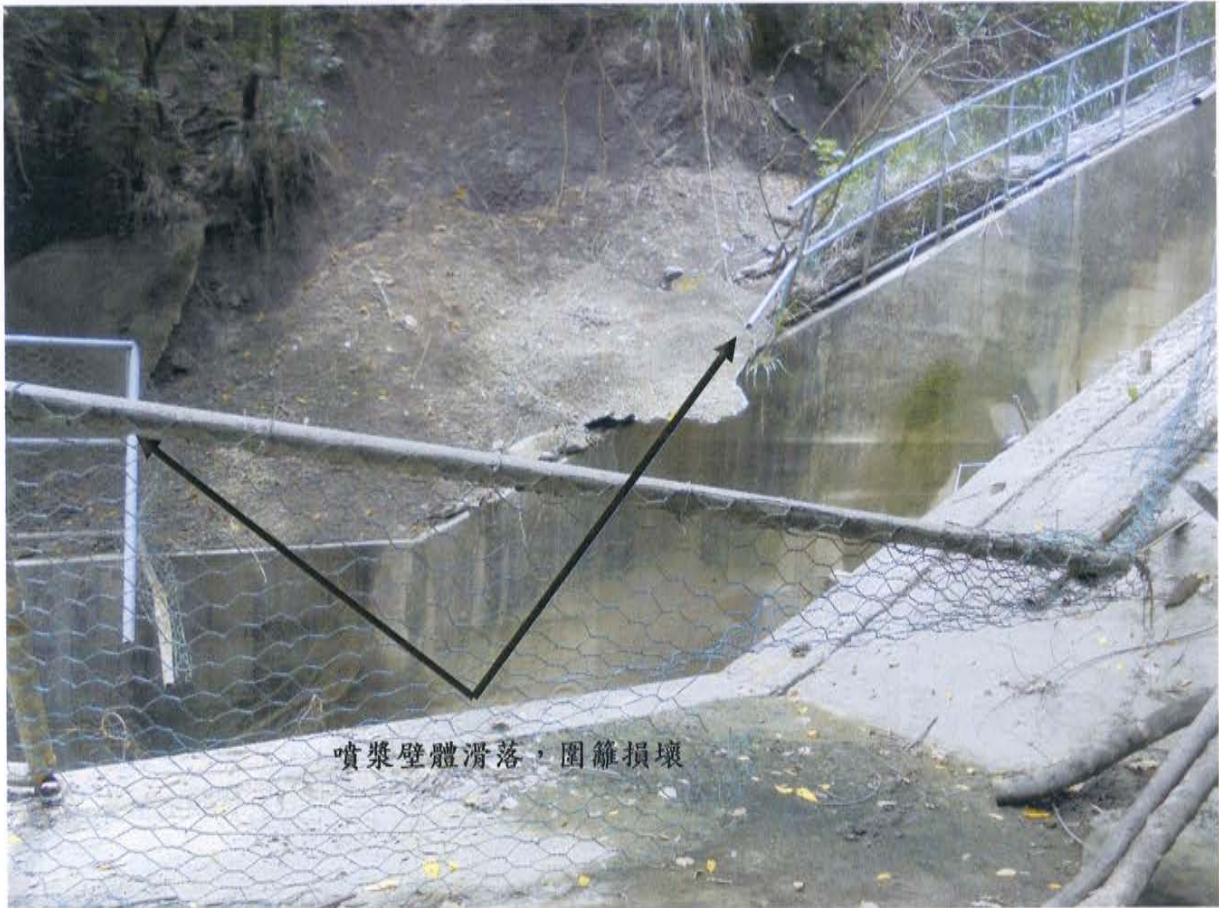
圖二十:引水隧道出口洩槽3號靜水池右側噴漿壁體滑落，造成圍籬損壞左右各約20公尺
