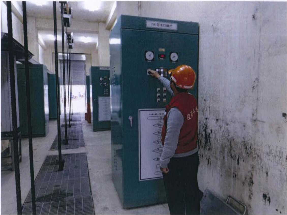
圖二十七：取水口控制閘門-控制箱電源檢查
