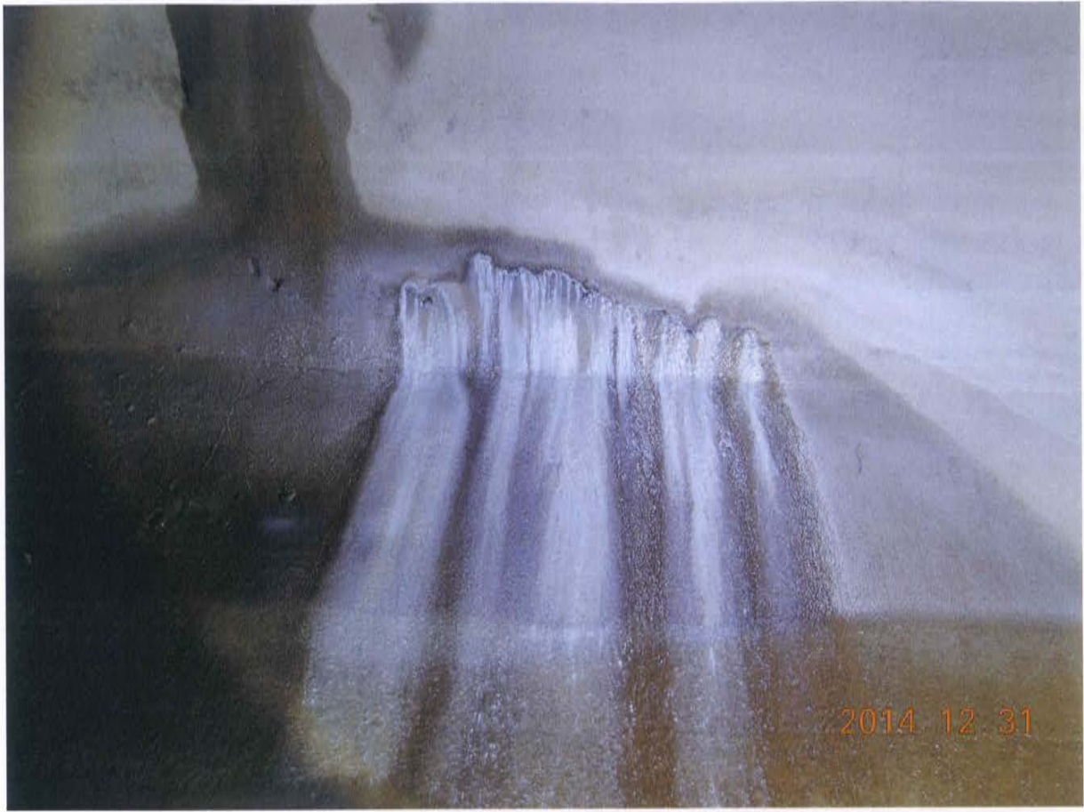
圖十九:隧道襯砌施工縫滲水(0k+583)
