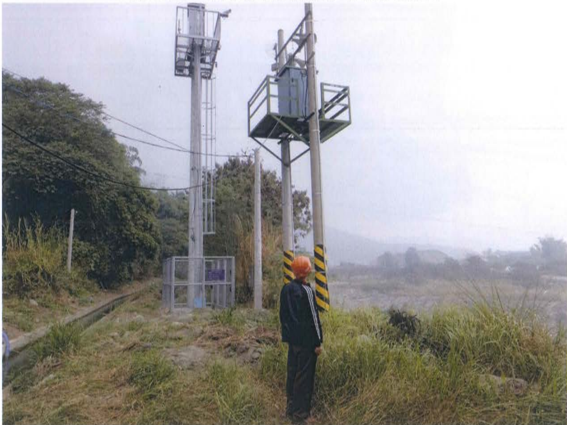
圖三十四：放水警報廣播系統-甲仙大橋設備檢查
