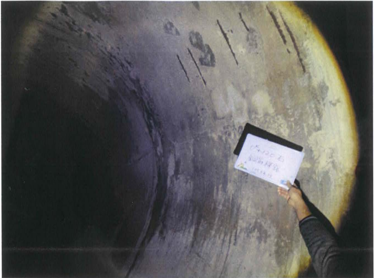
附圖十五 隧道襯砌鋼筋保護層不足鋼筋裸露 0k+120
