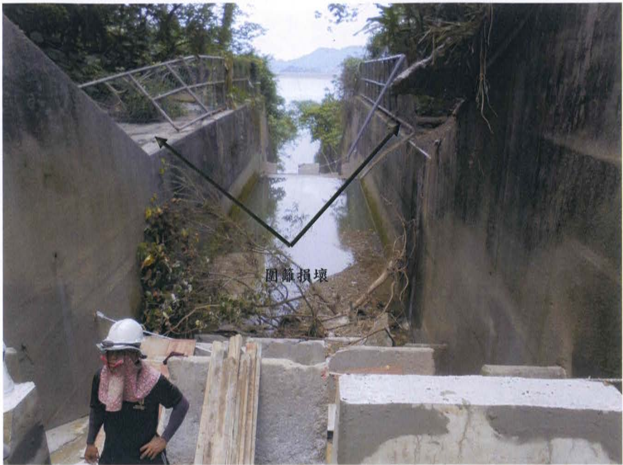
圖二十一:引水隧道出口洩槽3號靜水池右側噴漿壁體滑落，造成圍籬損壞左右各約20公尺
