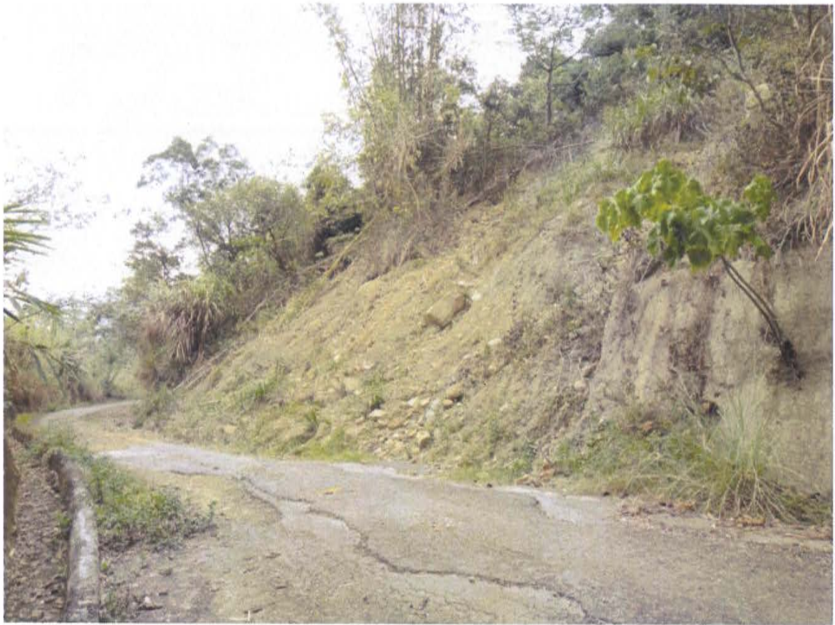
附圖十一 引水隧道出口聯外道路崩塌處將辦理修復
