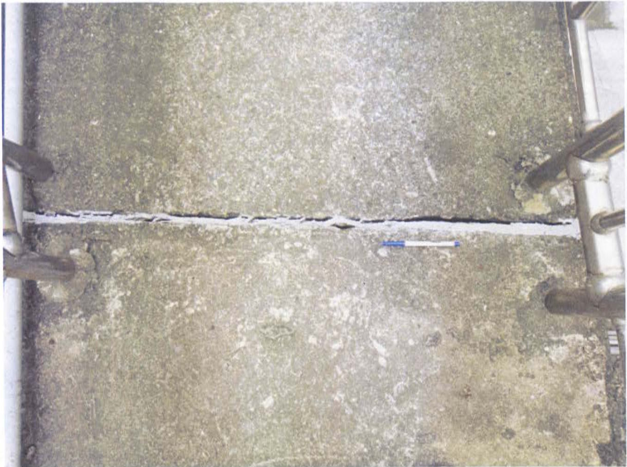
附圖七 防洪牆擴張情形
