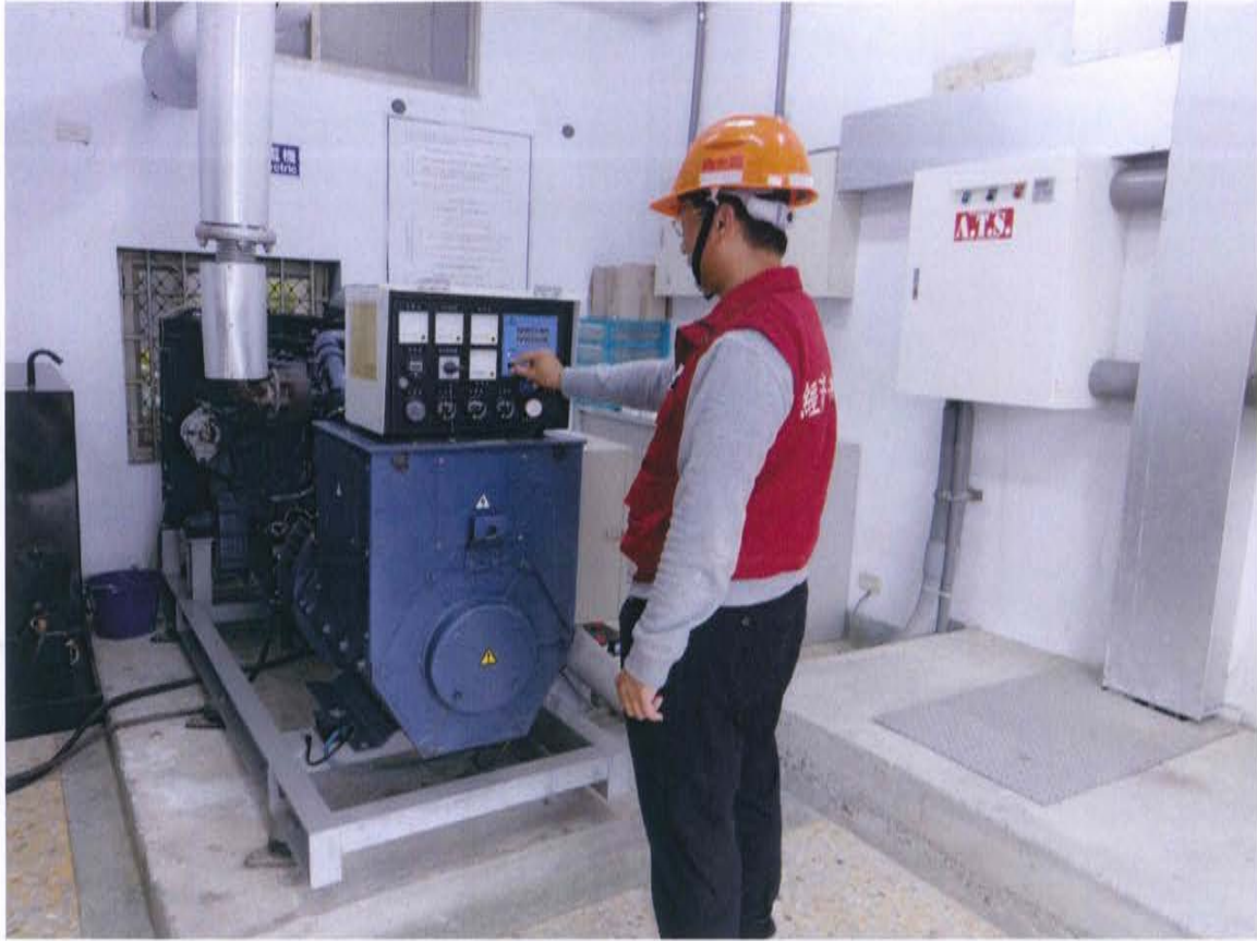
圖三十五：控制室緊急發電機(125KW)檢查
