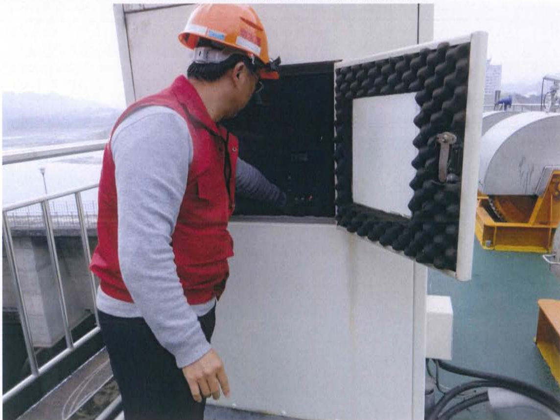
圖三十六：備援緊急發電機(60KW)檢查
