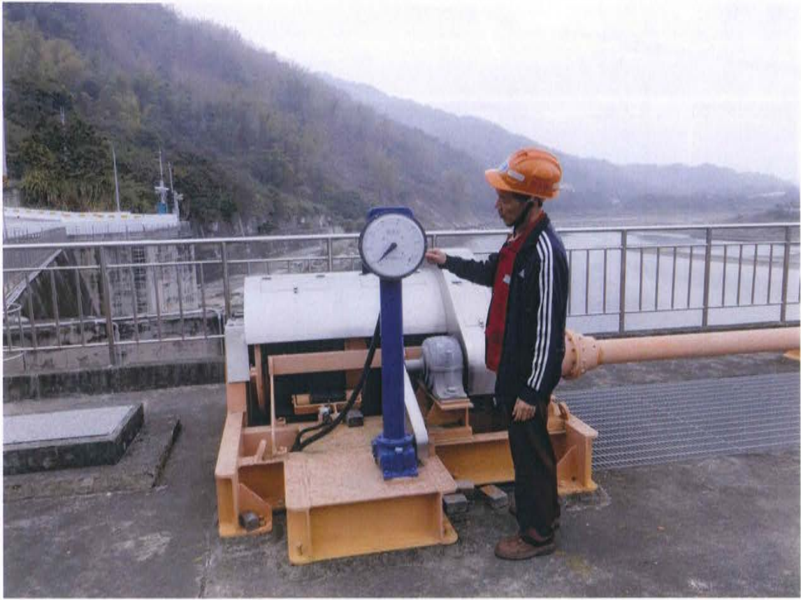
圖二十五：排砂道擋水閘門-開度指示器檢查
