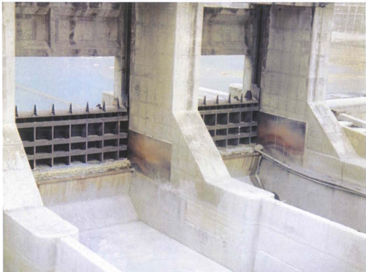
附圖二 2、3號排砂道堰面鋼板局部磨蝕及滲水
