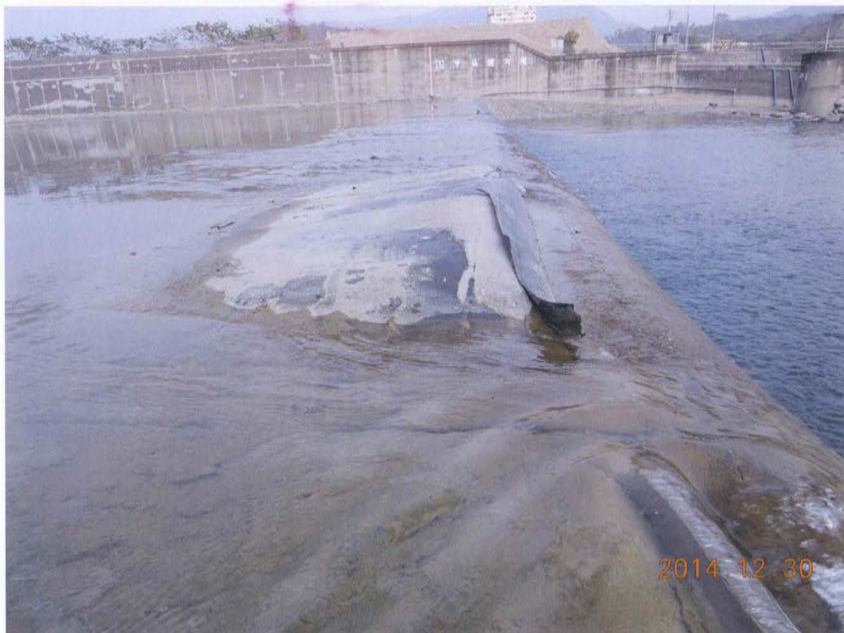
圖三: 覆蓋之橡皮因內部淤砂而隆起之情形，擬於下游端開口，讓淤砂流出
