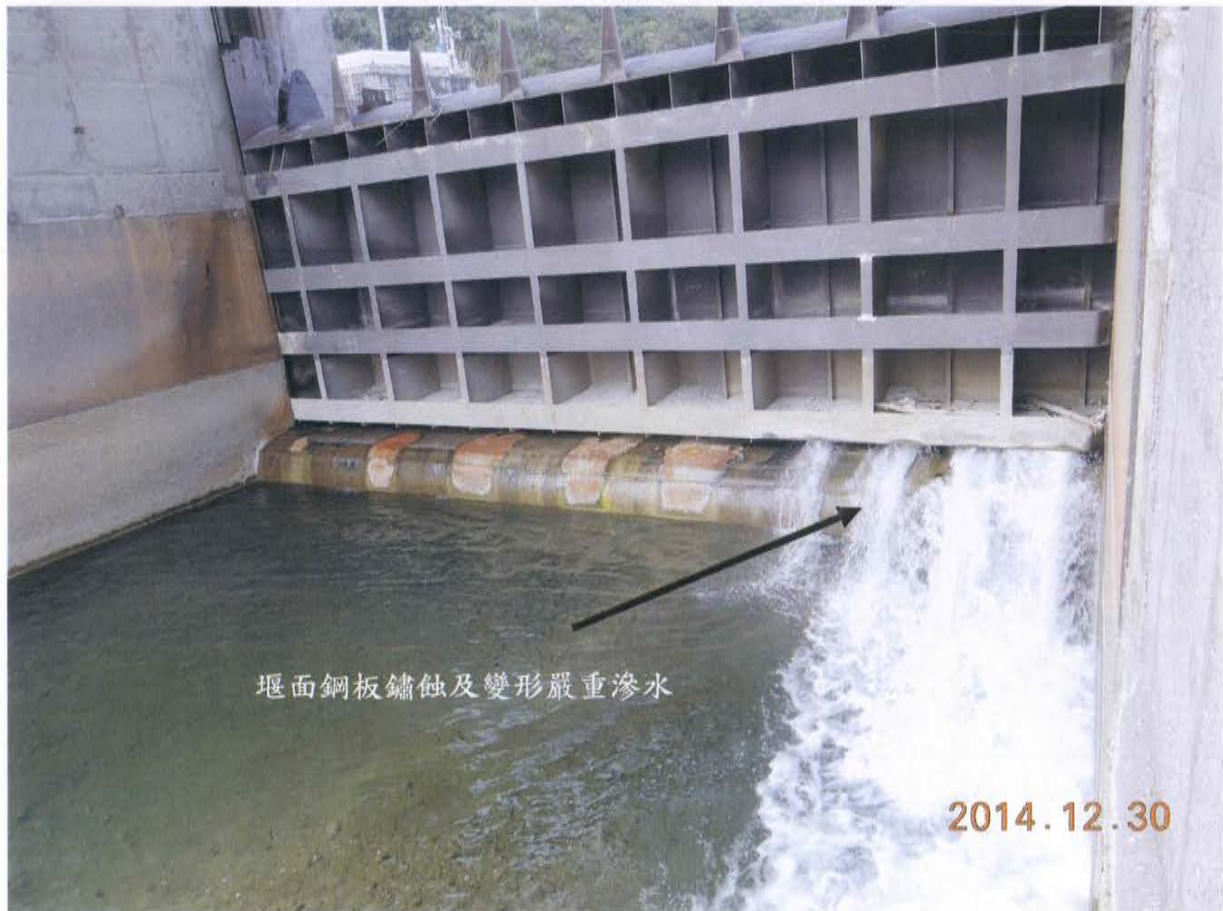
圖六:#3 排砂道堰面鋼板變形磨蝕及嚴重滲水情形
