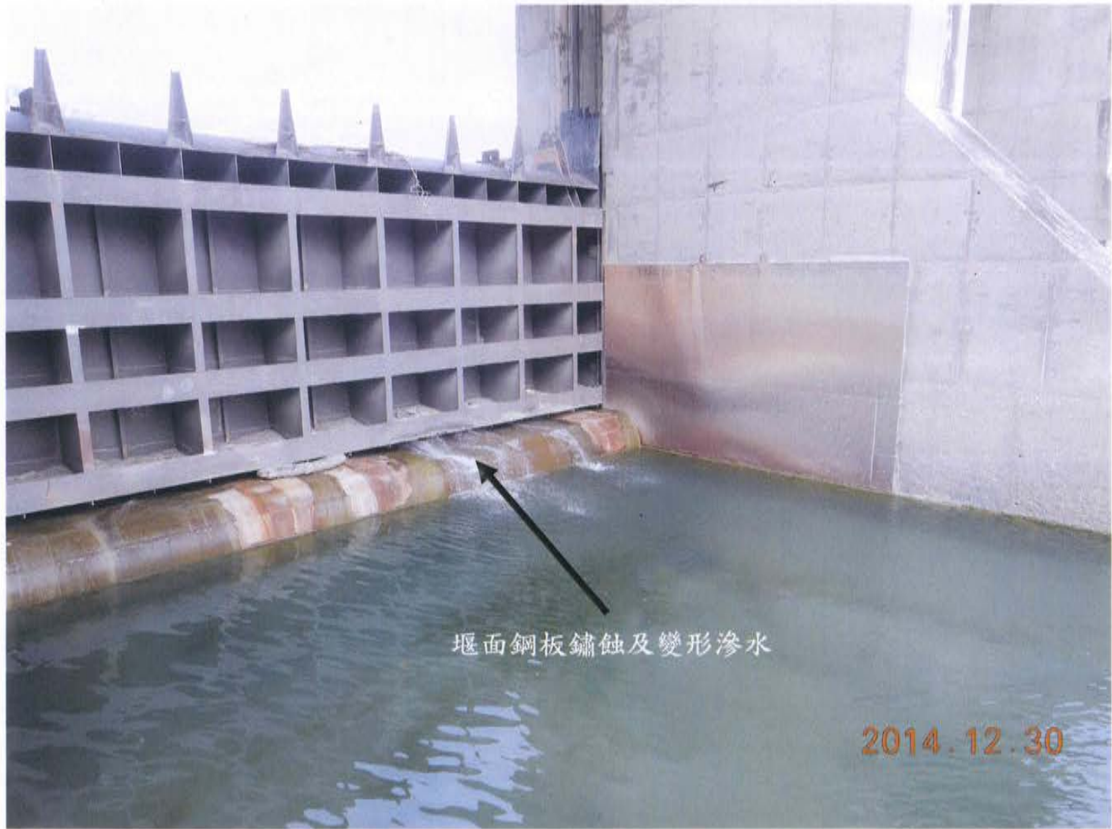
圖五:#2 排砂道堰面鋼板變形磨蝕及滲水情形
