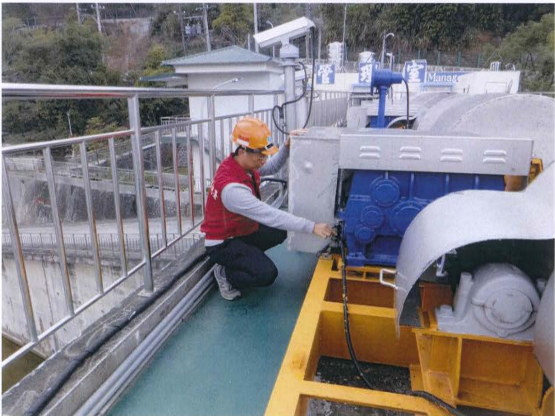
圖二十八：取水口控制閘門-齒輪箱油位檢查
