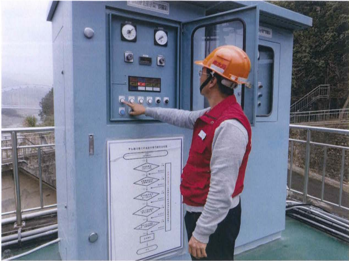
圖三十一：取水口沉沙池排砂閘門-電源及油壓馬達運轉檢查
