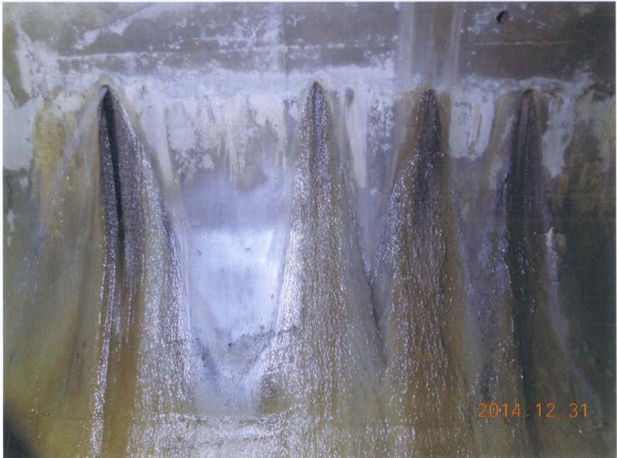
圖十八:隧道襯砌施工縫滲水(0k+118)
