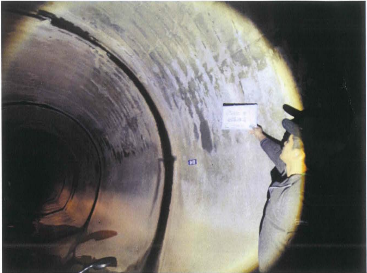
附圖十七 隧道襯砌鋼筋保護層不足鋼筋裸露 0k+550
