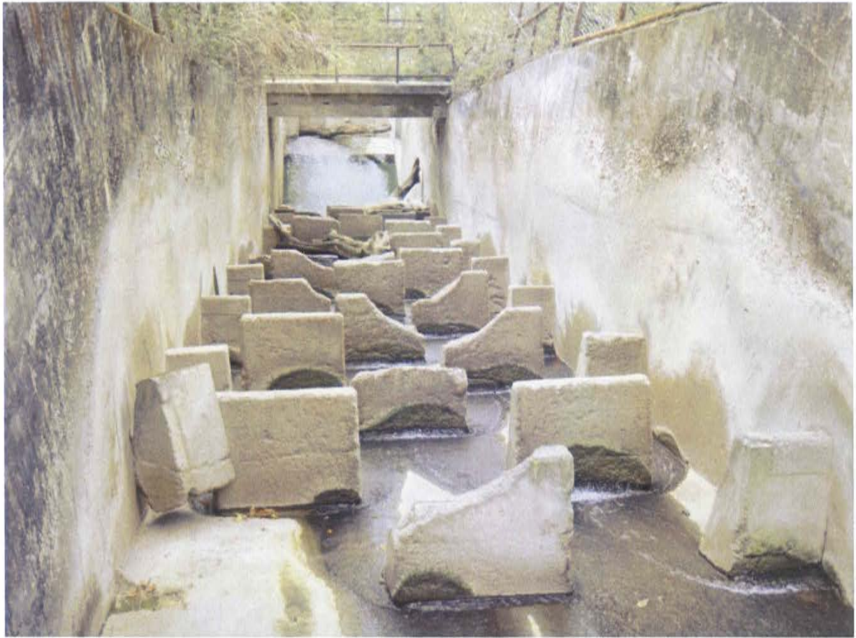
附圖九 引水隧道出口洩槽漂流木停留及齒塊損壞情形
