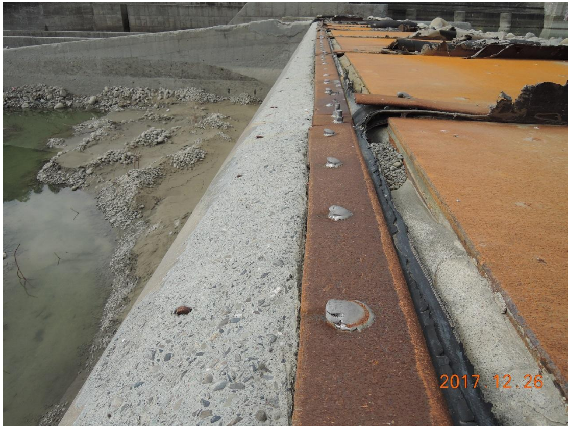
圖 1.1.3：溢流堰尾端混凝土局部磨損
