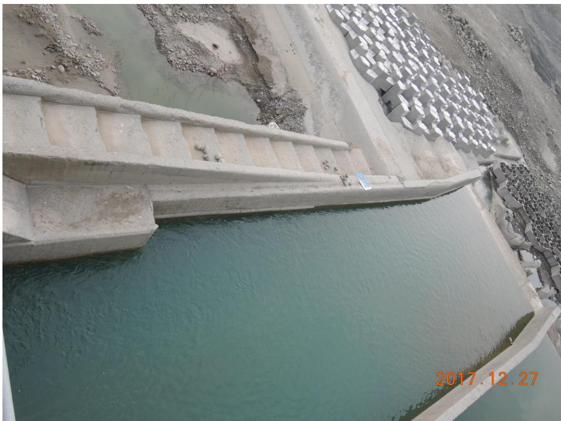
圖 1.2.2：#3 導流牆磨損較嚴重
