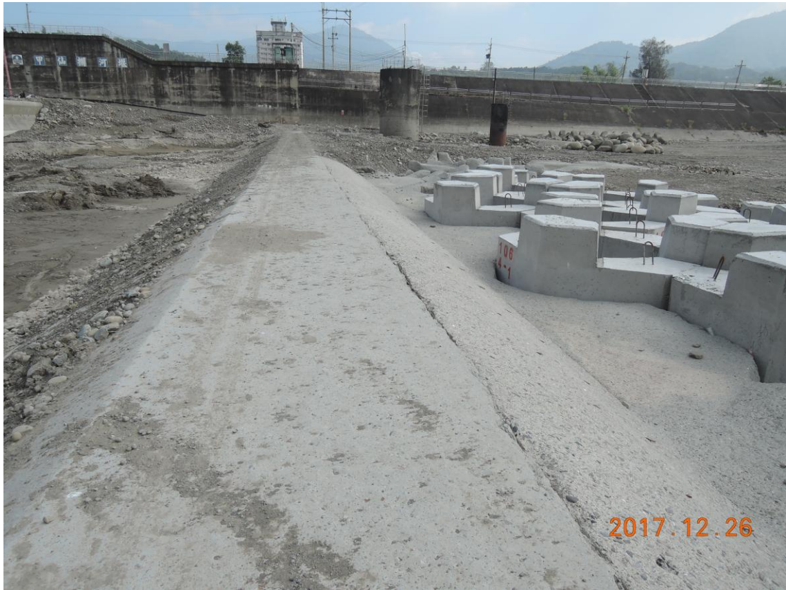
圖 3.1：落水池淤積及尾檻磨損
