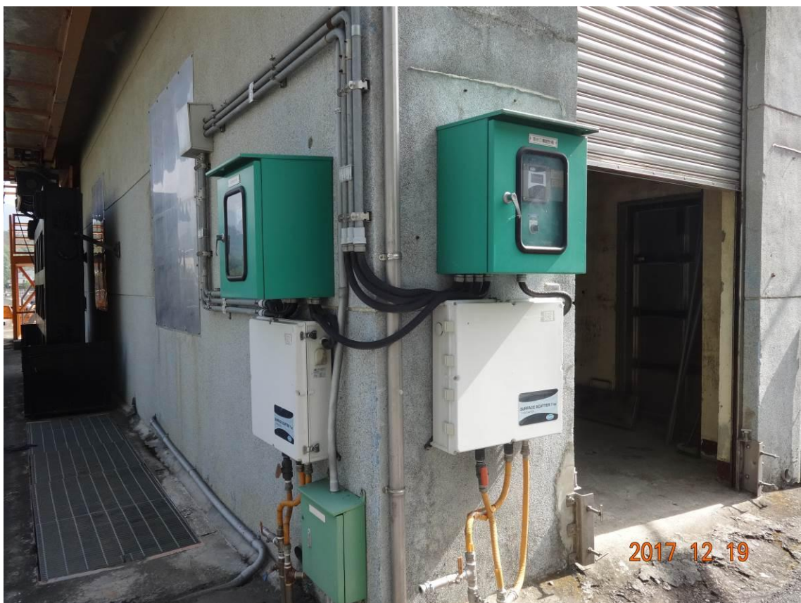
圖 6.2：監測儀器檢查-濁度計
