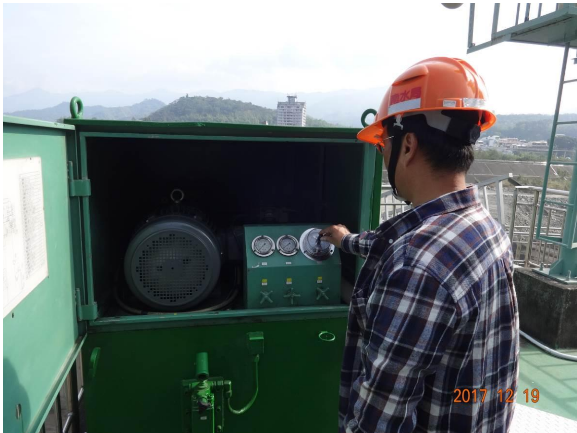
圖 4.4.2：沉沙池排砂閘門-油壓設備運轉檢查
