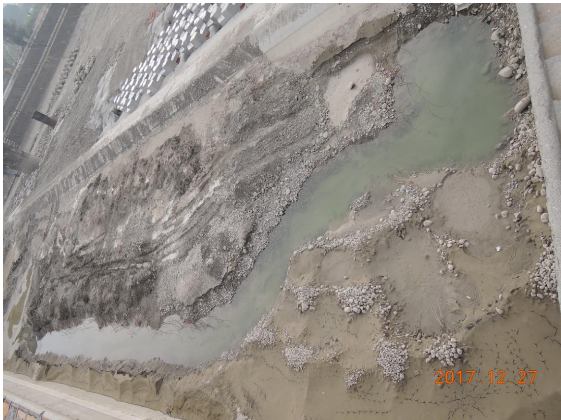
圖 3.2：落水池可見底版鋼筋裸露
