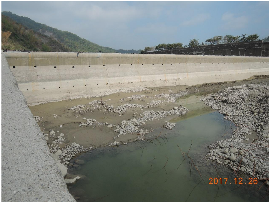
圖 1.1.1：溢流堰堰體下方有局部鋼筋裸露情形
