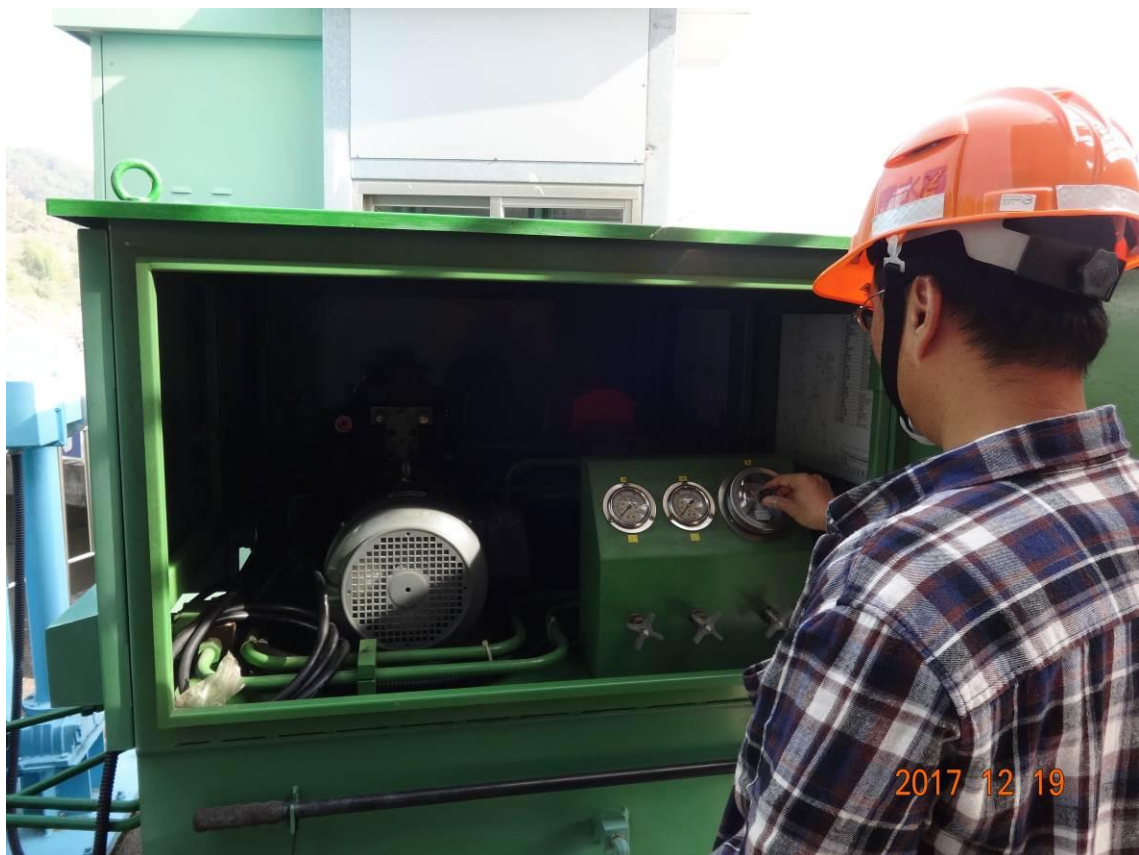
圖 4.3.2：取水口排砂閘門-油壓設備運轉檢查
