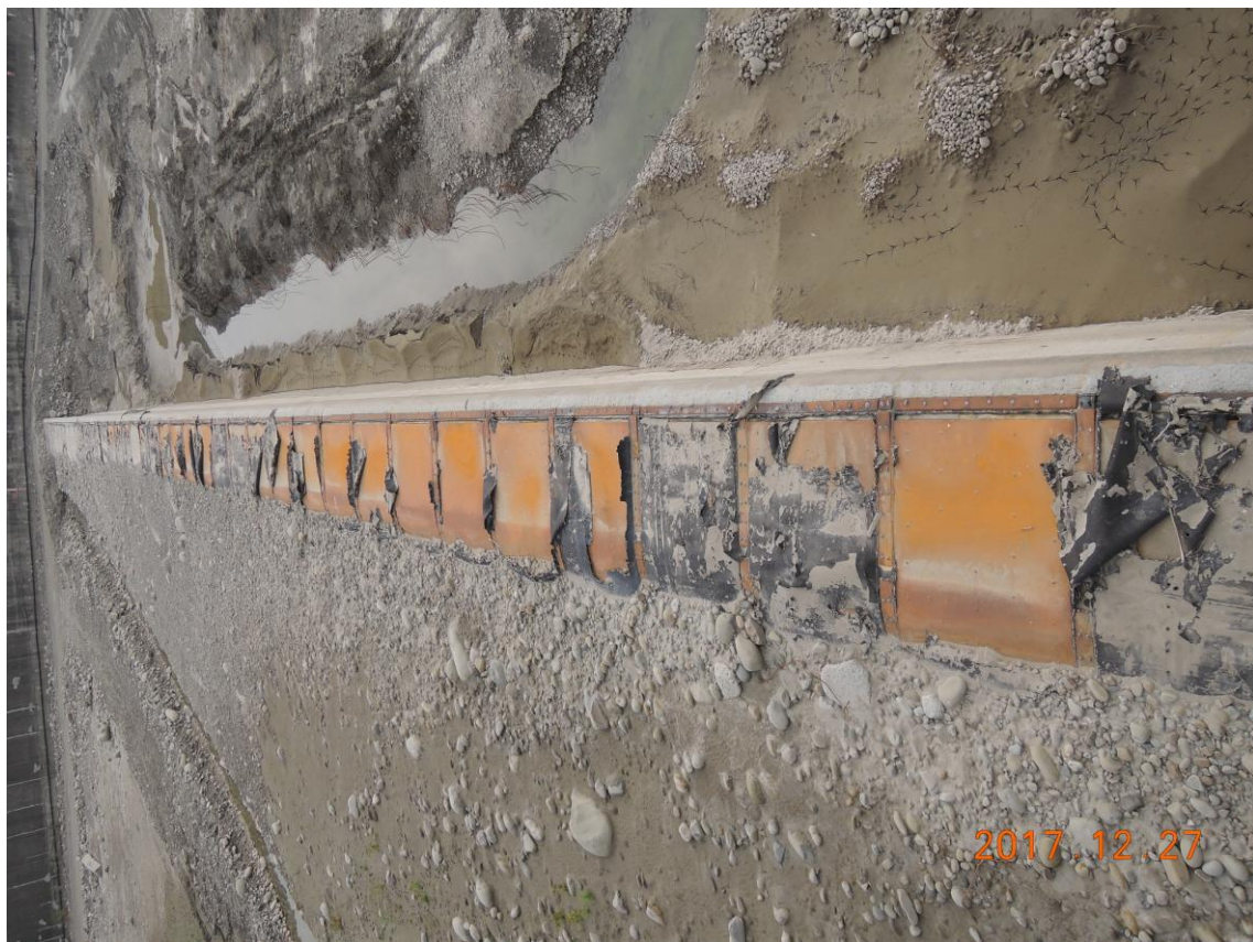
圖 1.1.2：溢流堰堰頂現況鋼板橡膠墊破損嚴重損
