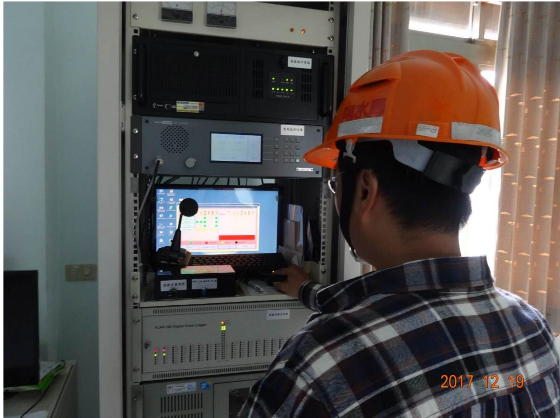
圖 5.1.1：放水警報廣播系統-警報廣播測試
