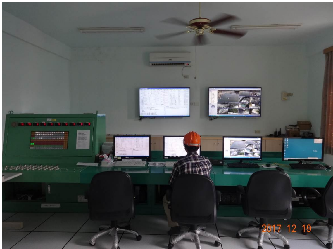
圖 6.4：監測儀器檢查-控制室監控主機
