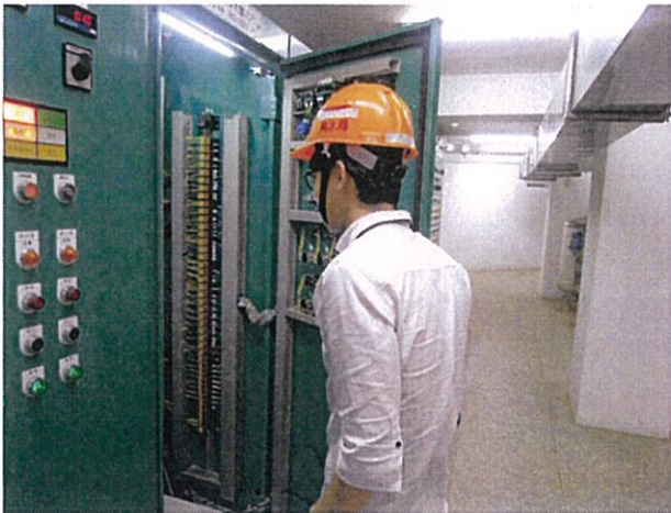
橡皮壩一至八號控制盤及燈號檢查
