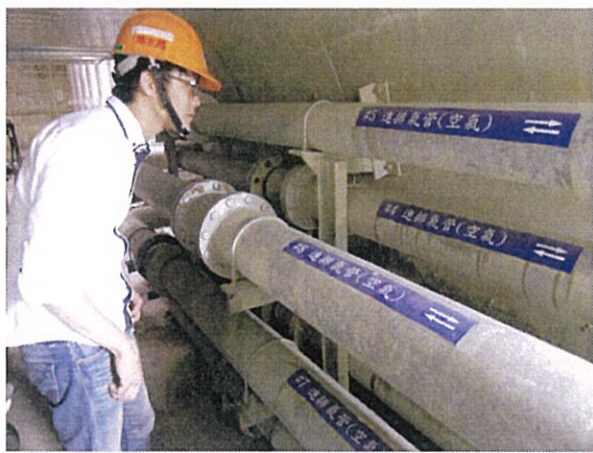
橡皮壩一至八號排氣管路檢查
