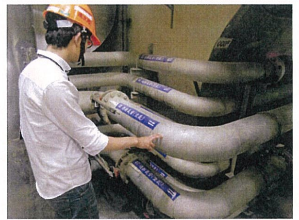
橡皮壩一至八號排氣管路檢查
