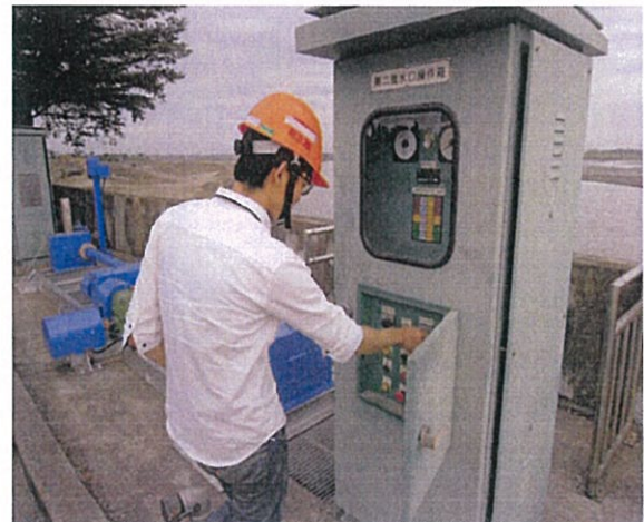
進水口一至十四號閘門控制盤檢查
