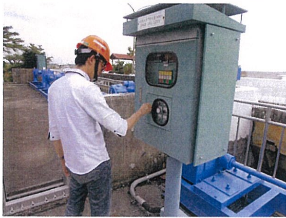
取水路一至三號閘門控制盤檢查
