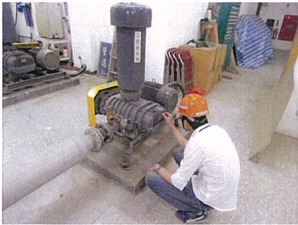
橡皮壩一至三號鼓風機檢查
