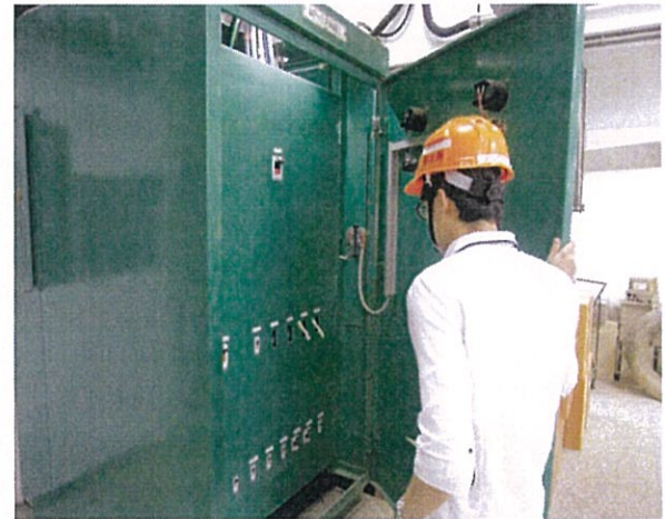
電力系統控制盤檢查
