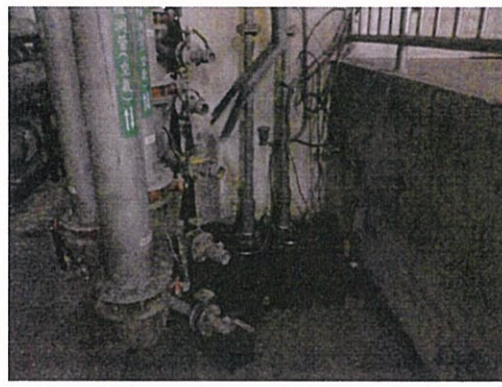
12. 廊道輕微滲水
