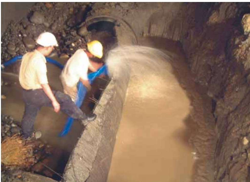
照片 3-2-9 輸水幹管裂管搶險
