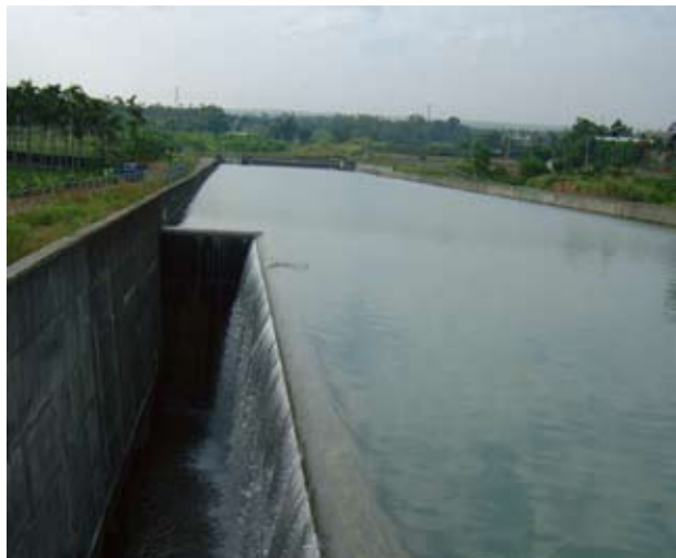
照片 3.2.1.3 第二號貯水池（蓄水）
