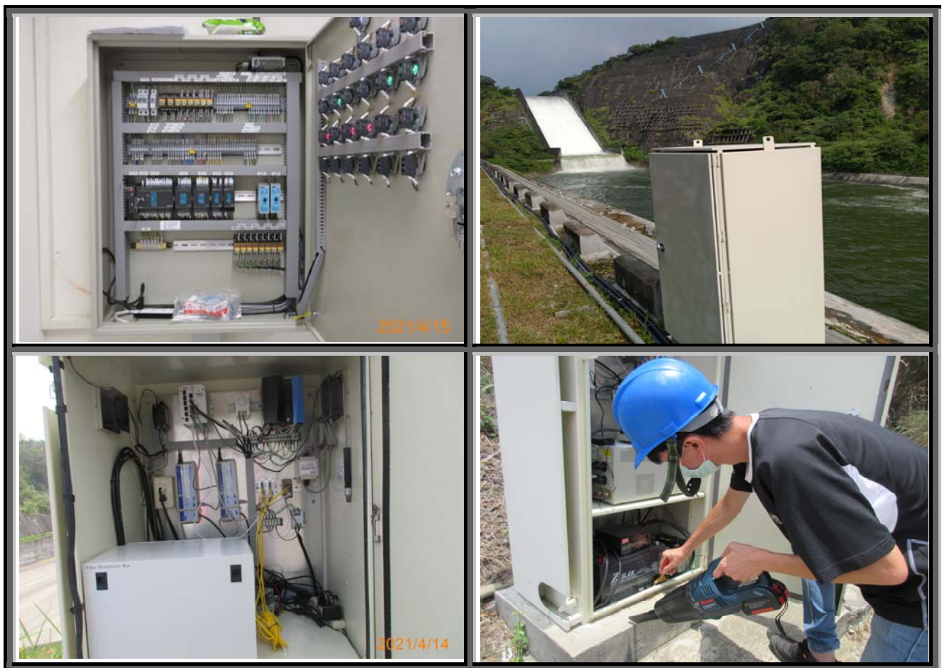
圖 24. 機房環控系統各站相片
