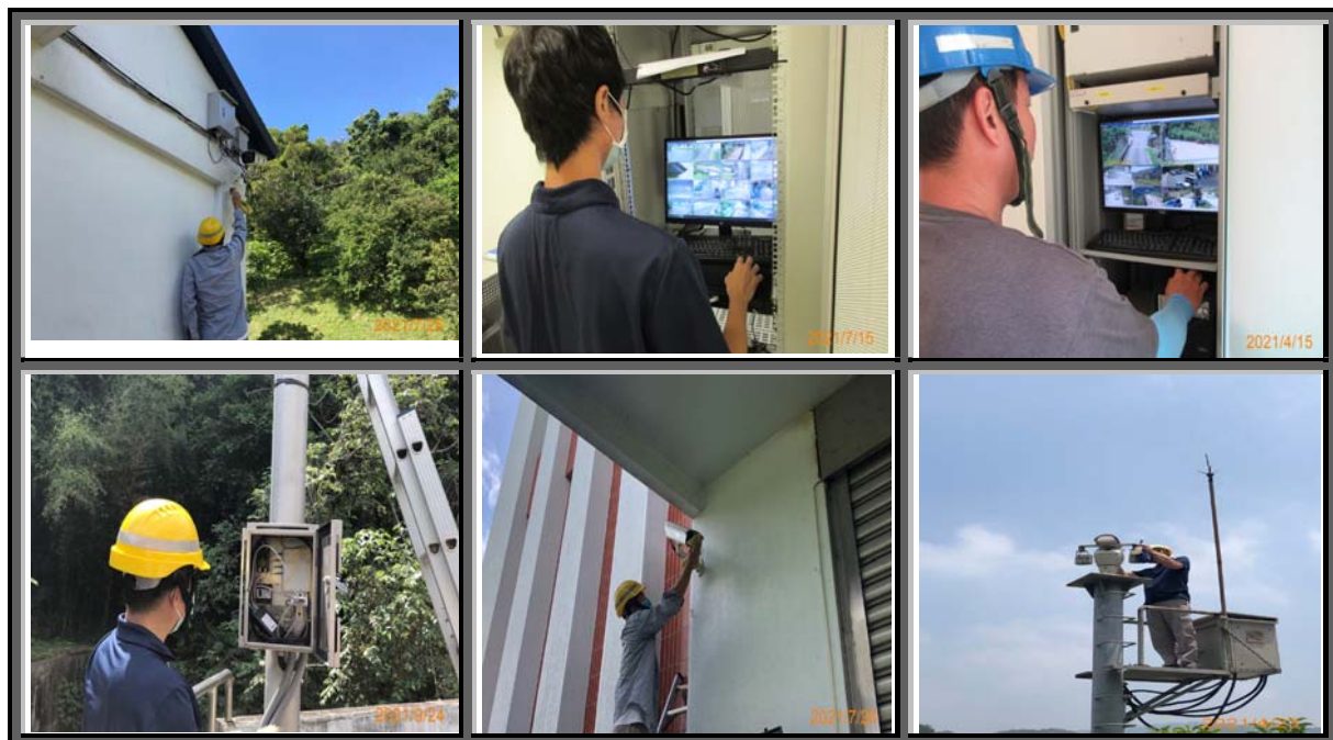
圖 15. CCTV 監控系統各站相片
