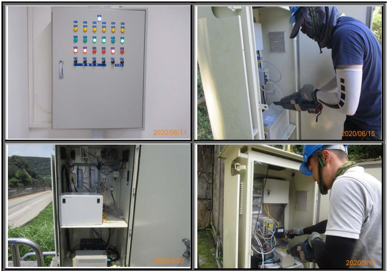
圖 24. 機房環控系統各站相片
