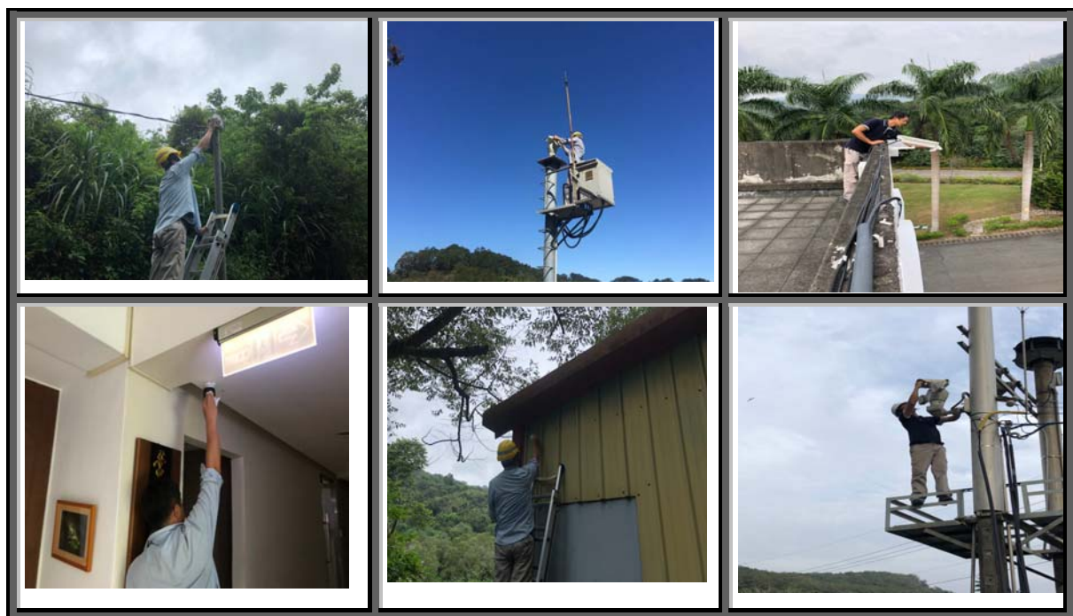
圖 15. CCTV 監控系統各站相片
