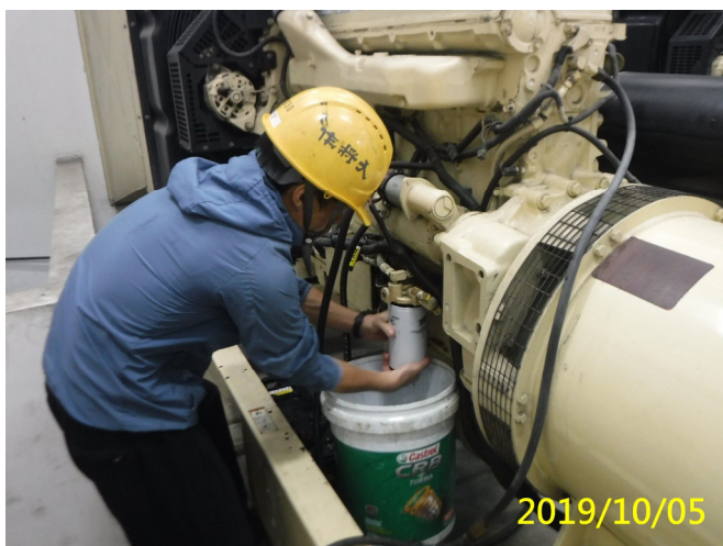
45. 108/10/5 水工機械用 350KW 發電機更換柴油濾清器
