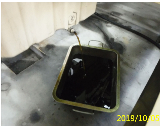
41. 108/10/5 水工機械用 350KW 發電機更換機油
