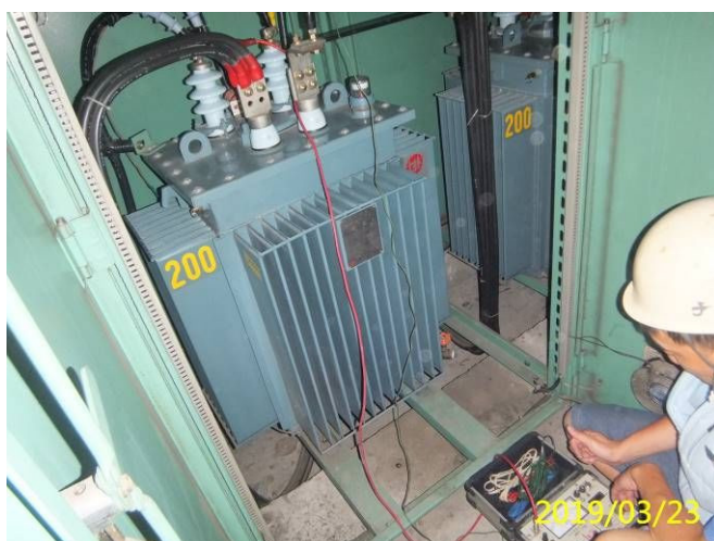
3. 108/3/23 集集攔河堰高壓電力設備定期檢驗
