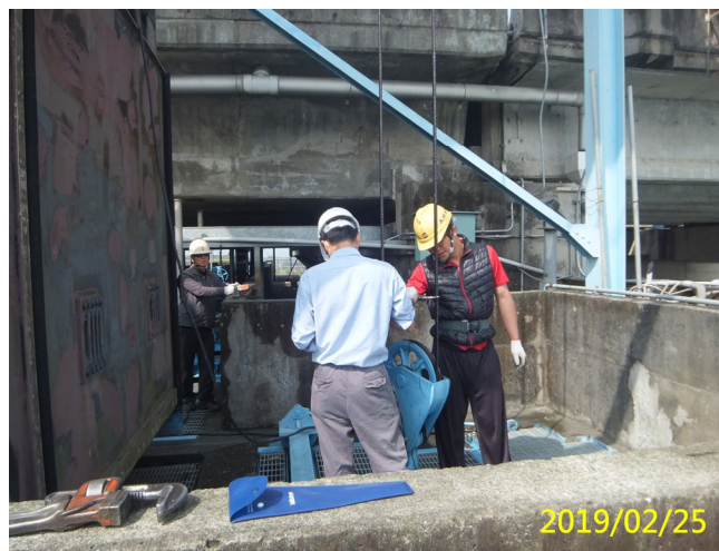
2. 108/2/25 魚道 10T 吊車定期工檢
