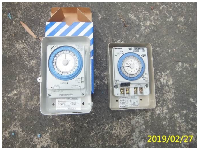
1. 108/2/27 北岸進水口閘門區照明定時開關故障更換新品
