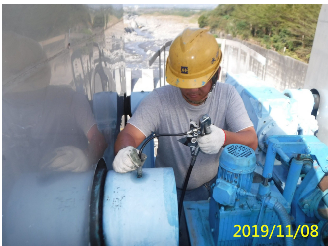
55. 108/11/08 溢洪道吊門機各軸承黃油更新 加注潤滑
