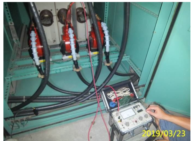
2. 108/3/23 集集攔河堰高壓電力設備定期檢驗
