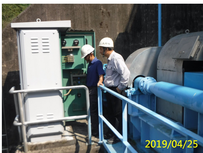
5. 108/4/25 電機技師至排砂道閘門執行技師業務
