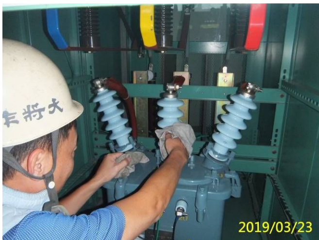
1. 108/3/23 集集攔河堰高壓電力設備定期檢驗
