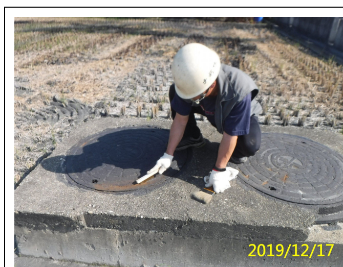
1. 108/12/17 人孔蓋生鏽進行除鏽油漆前
