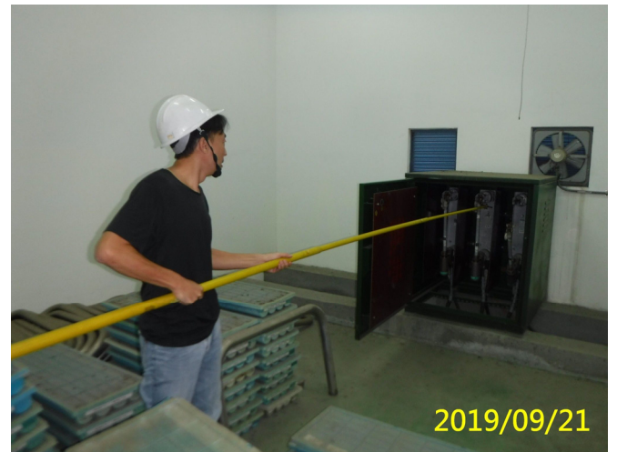
8. 108/9/21 集集攔河堰高壓電力設備定期檢驗
