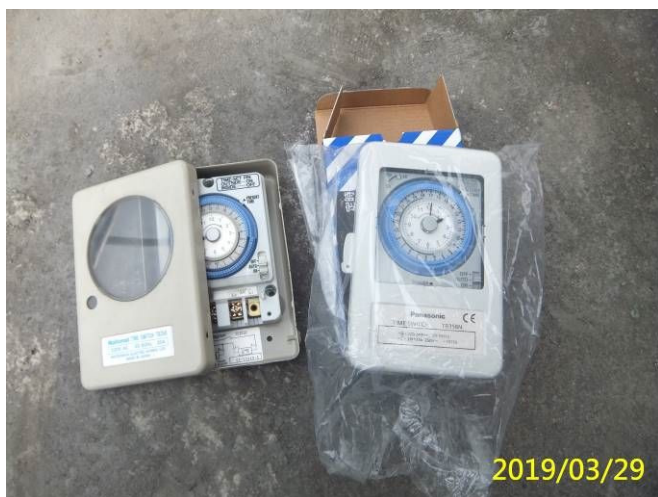
3. 108/3/29 北岸進水口閘門區照明箱內定時開關故障更換新品
