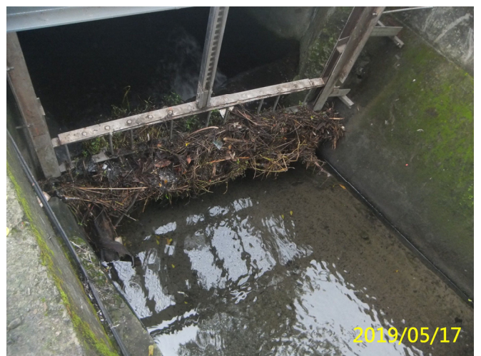
4. 108/5/17 集集大排攔污柵垃圾阻塞進行清除前
