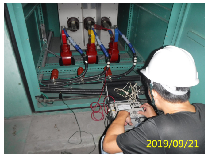
10. 108/9/21 集集攔河堰高壓電力設備定期檢驗
