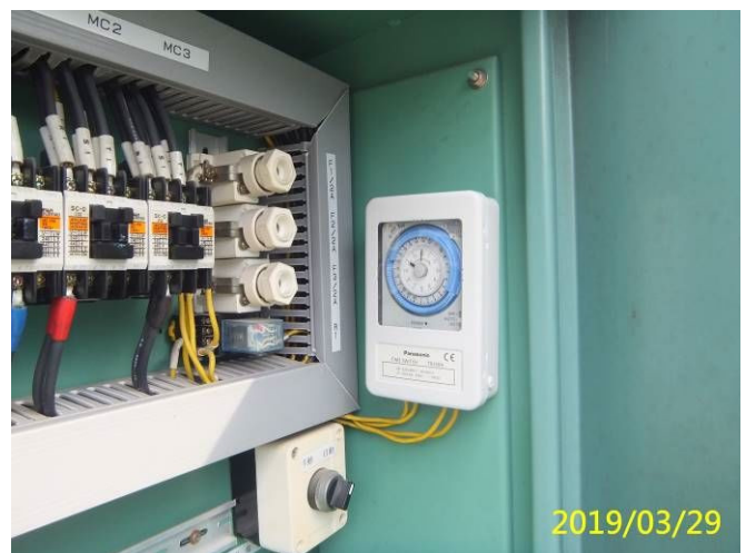
4. 108/3/29 北岸進水口閘門區照明箱內定時開關故障更換新品
