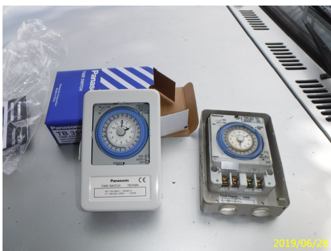
5. 108/6/28 南岸沉砂池景觀照明P3 照明盤內定時開關故障更換
