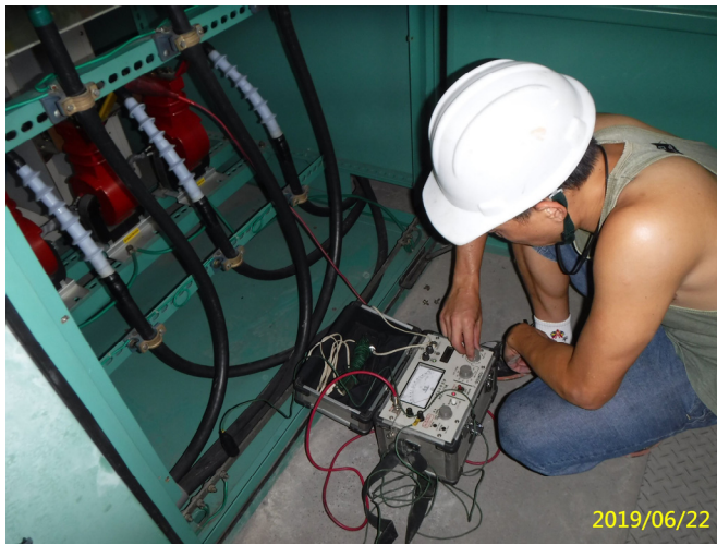
5. 108/6/22 集集攔河堰高壓電力設備定期檢驗
