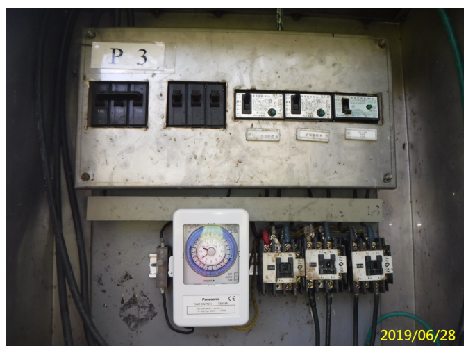
6. 108/6/28 南岸沉砂池景觀照明P3 照明盤內定時開關故障更換
