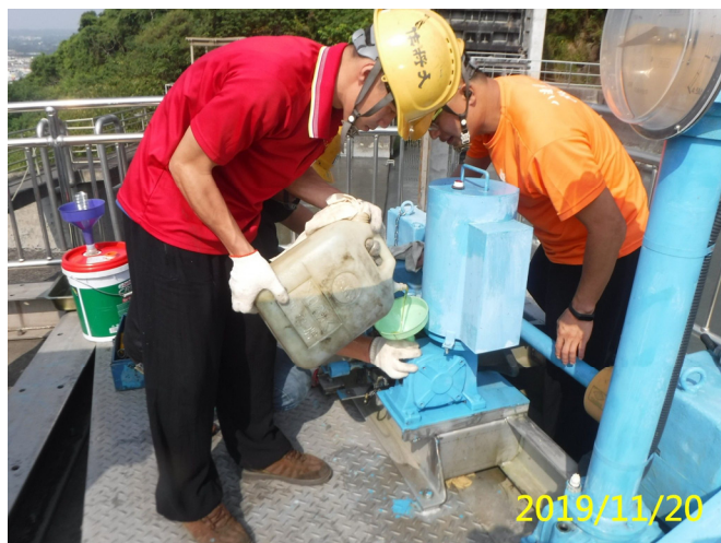
58. 108/11/20 同源圳及八卦旱灌閘門年度更 換齒輪箱機油
