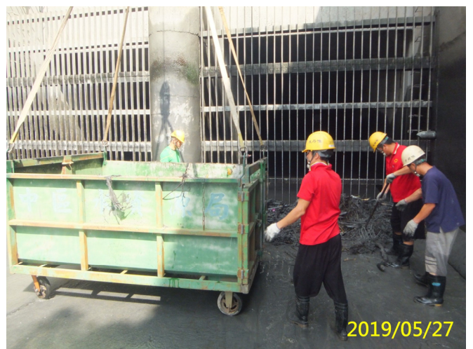
6. 108/5/27 南岸聯絡渠道攔污柵垃圾阻塞清除中
