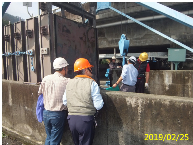
1. 108/2/25 魚道 10T 吊車定期工檢
