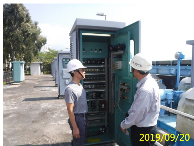
6. 108/9/20 機械技師至北岸進水口閘門執行技師業務
