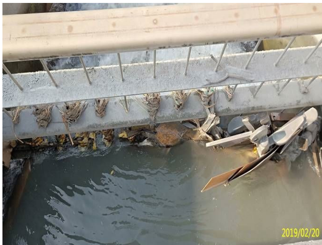
1. 108/2/20 南岸聯絡渠道攔污柵內垃圾阻塞清除前
