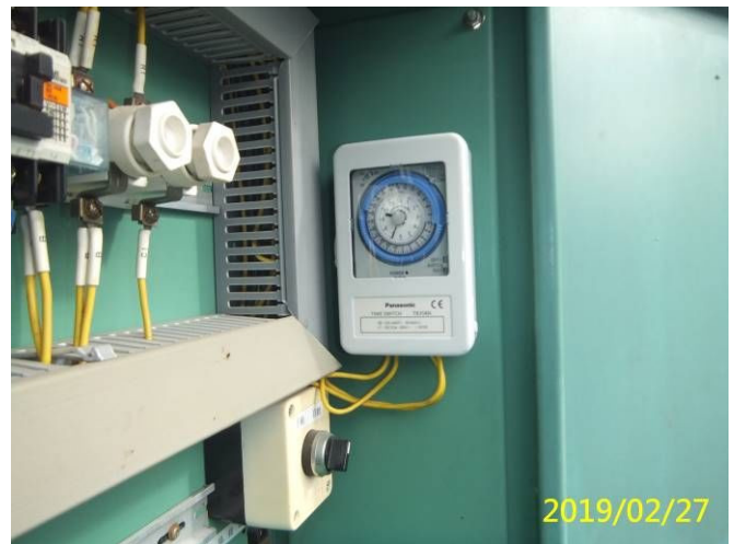
2. 108/2/27 北岸進水口閘門區照明定時開關故障更換新品
