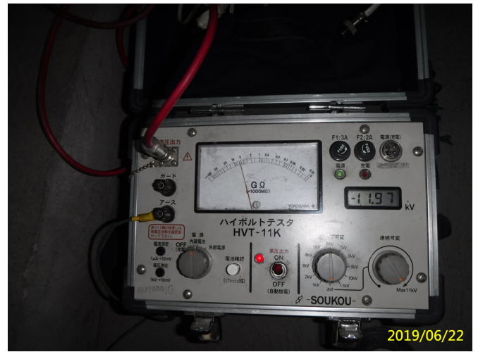
6. 108/6/22 集集攔河堰高壓電力設備定期檢驗
