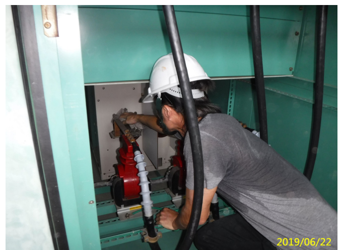
4. 108/6/22 集集攔河堰高壓電力設備定期檢驗
