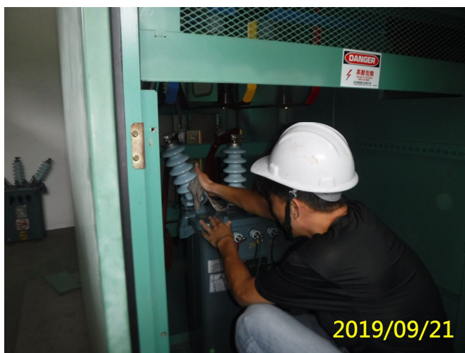
9. 108/9/21 集集攔河堰高壓電力設備定期檢驗
