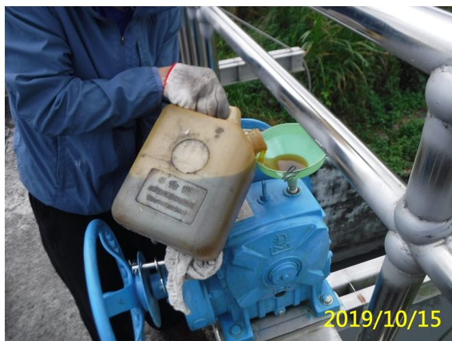
53. 108/10/15 十二甲自動閘門吊門機機油更換
