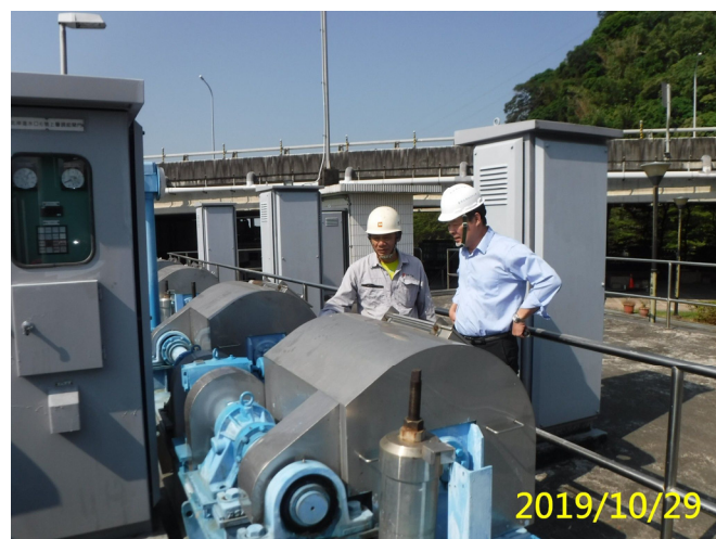
4. 108/10/29 機械技師至北岸進水口閘門執行技師業務
