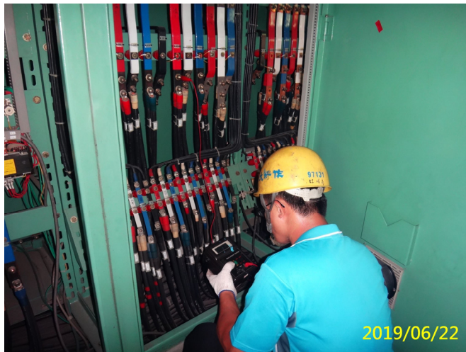
7. 108/6/22 集集攔河堰高低壓電力設備定期檢驗
