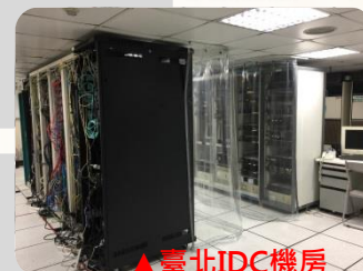
▲臺北IDC機房
